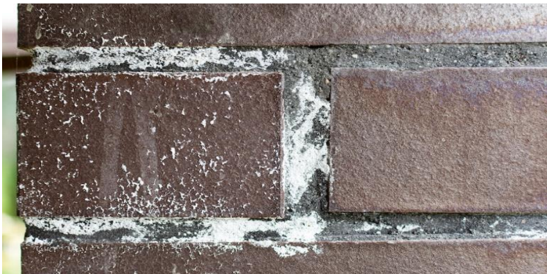
Figura 6 Representación de eflorescencias por moho
