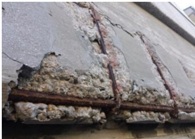
Figura 4 Representación de corrosión del acero
