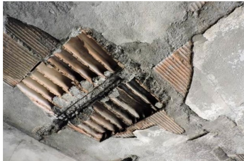
Figura 3 Representación de desconchamiento en el concreto
