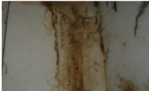
Figura 11 Representación de humedad por filtración
