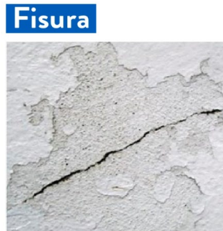
Figura 1 Representación de Fisura en el concreto
