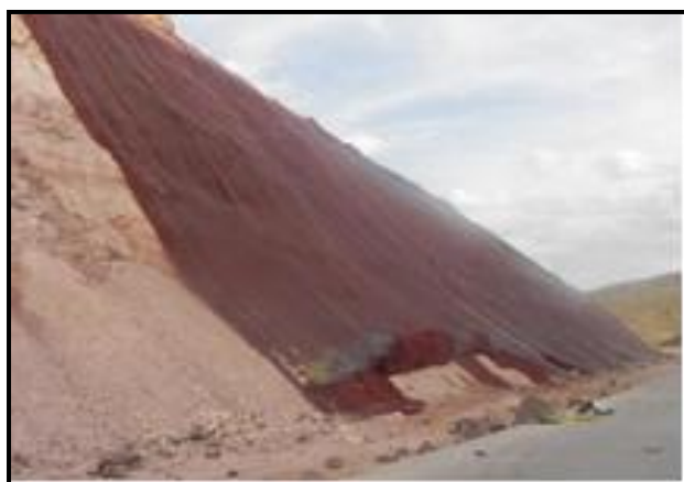
Fotografía 1. Estabilidad De Talud Con Biomanta De Fibra De Coco En El Proyecto Libramiento Oriente De Chihuahua. [Fuente Propia]
