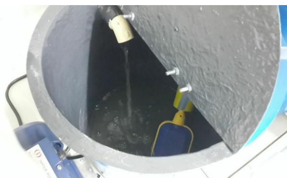
Figura 38. Tanques de agua filtrada.
