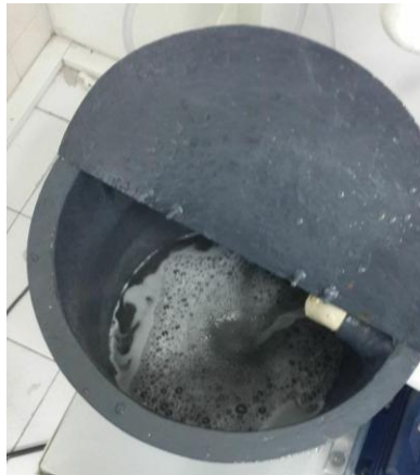
Figura 36. Tanque de agua tratada
