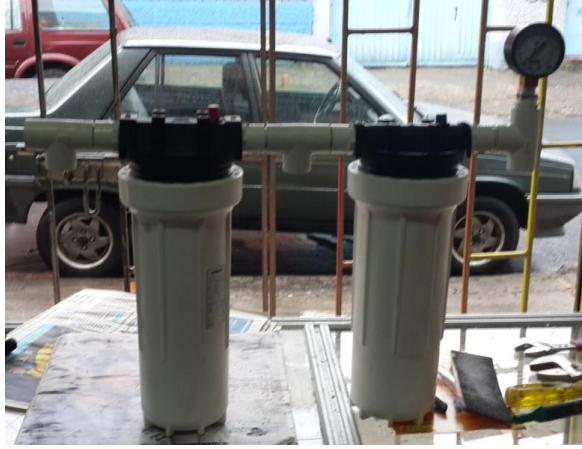
Figura 13. Carcasa y membranas instaladas con su respectivo manómetro.
