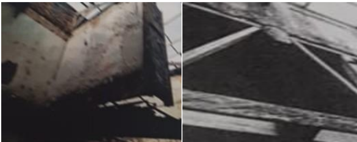
Figura 4. Patologías del teatro San Jorge 3. De izquierda a derecha, muro descolgado, mutilación de columna. Tomado de “Diagnóstico técnico”. Instituto Distrital de Patrimonio Cultural (2018).
