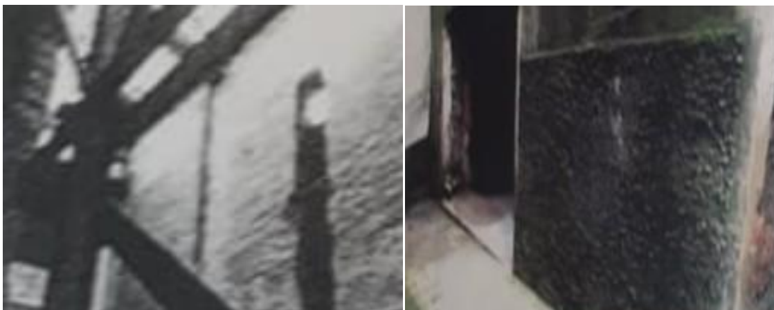
Figura 2. Patologías del teatro San Jorge 1. De izquierda a derecha, grietas en los muros, presencia de moho. Tomado de “Diagnóstico técnico”. Instituto Distrital de Patrimonio Cultural (2018).
