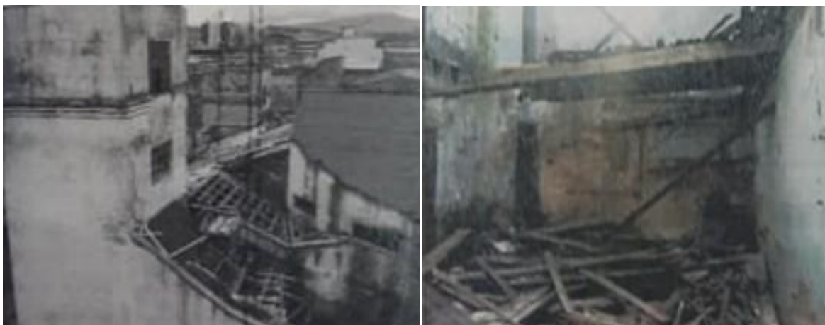
Figura 3. Patologías del teatro San Jorge 2. De izquierda a derecha, filtración en la cubierta, caída del entramado. Tomado de “Diagnóstico técnico”. Instituto Distrital de Patrimonio Cultural (2018).
