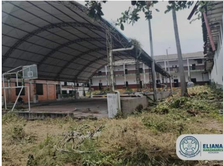
Figura 4 Estado actual del equipamiento.
