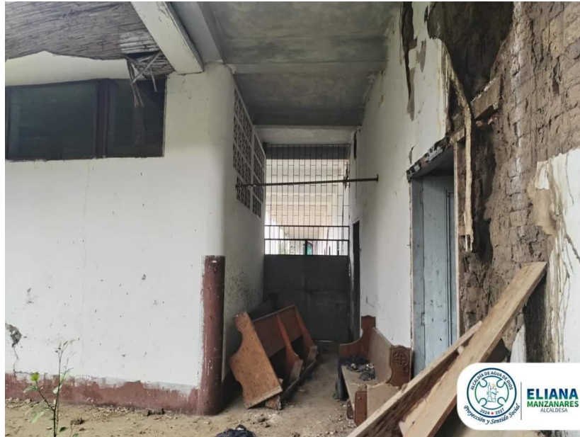
Figura 2 Estado actual del equipamiento.
