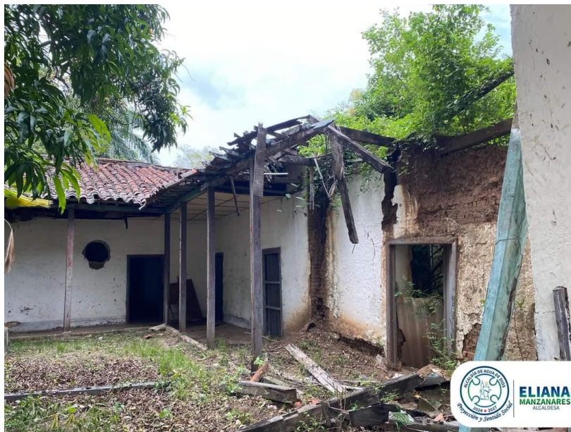
Figura 3 Estado actual del equipamiento.
