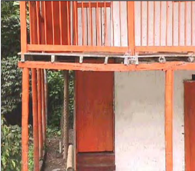
[Figura 10] AIS (2002) Flexión de elemento por longitud excesiva para el tamaño de la sección.
