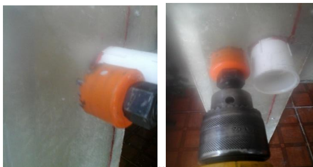
Ilustración 12. Se perforan los lugares de los tanques donde va pasar tubería Fuente: Elaboración propia (2016)
