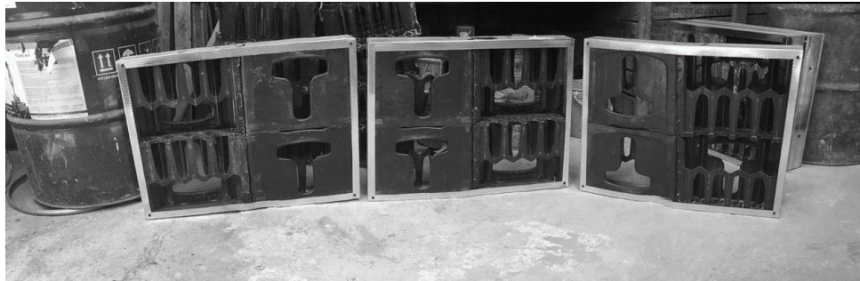
Figura 37 Muretes sin pañete
