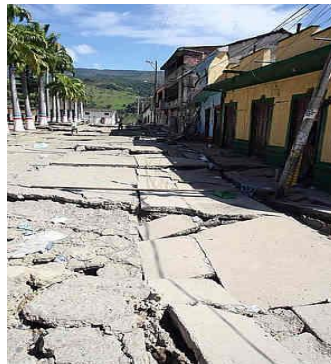
Figura 1. Arcillas expansivas de Gramalote-Santander
