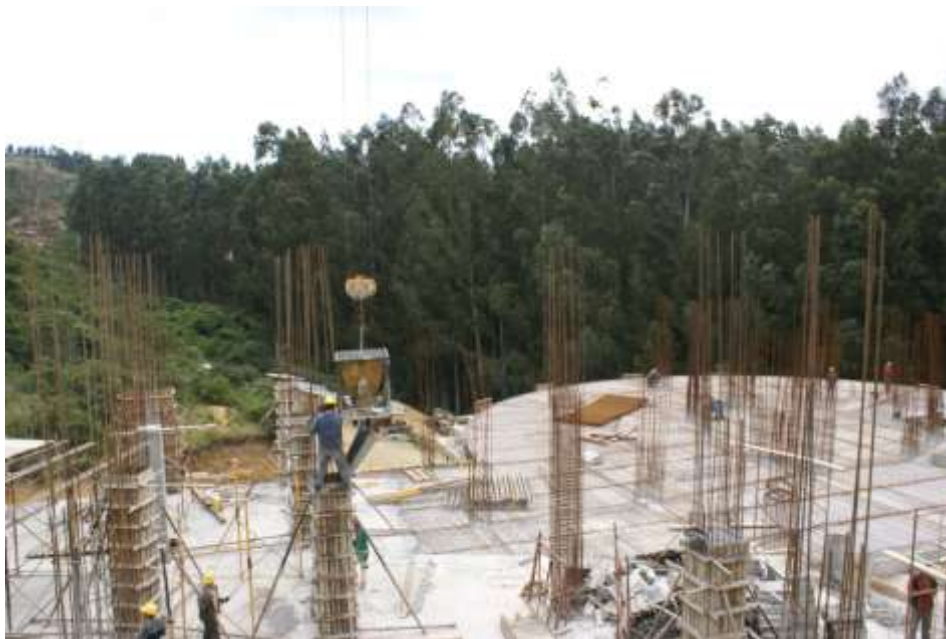
Figura 27. Falta de arnés y anclajes.
