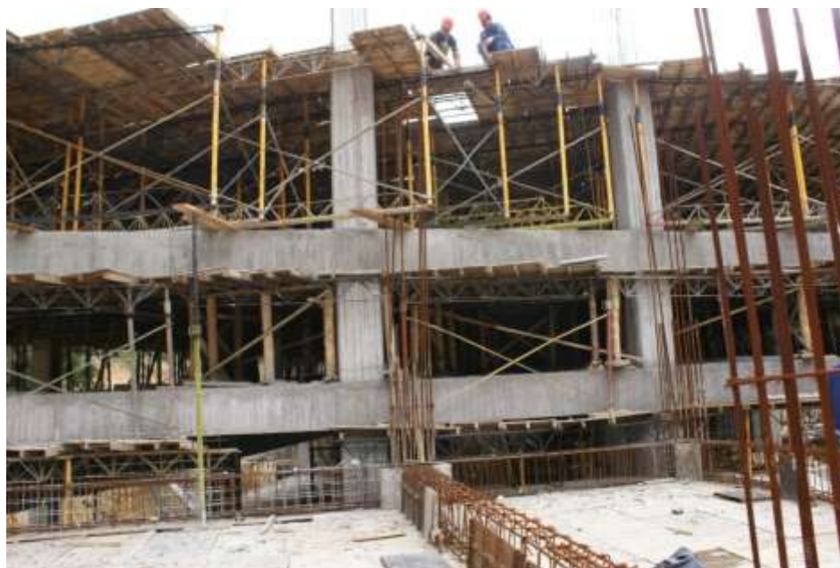
Figura 25. Falta de redes de seguridad.
