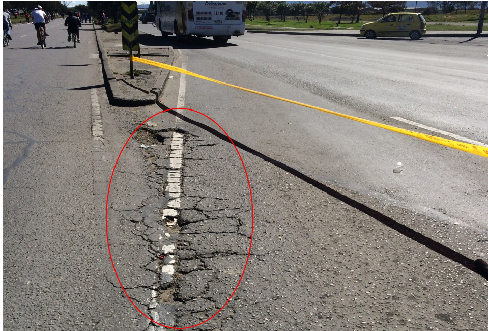
Imagen 52. Superficie de rodadura. Av. Boyacá con calle 12B. Sur-norte
