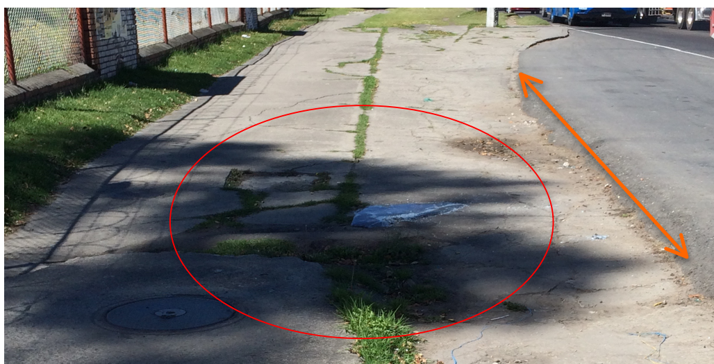
Imagen 65. Estado del andén Bavaria
