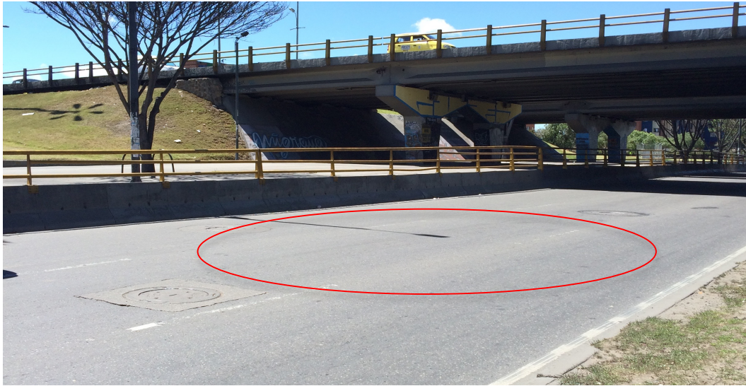
Imagen 48. Ausencia de demarcación de carriles. Av. Boyacá con Av. Américas
