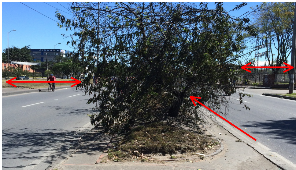
Imagen 37. Obstrucción de árboles en el separador
