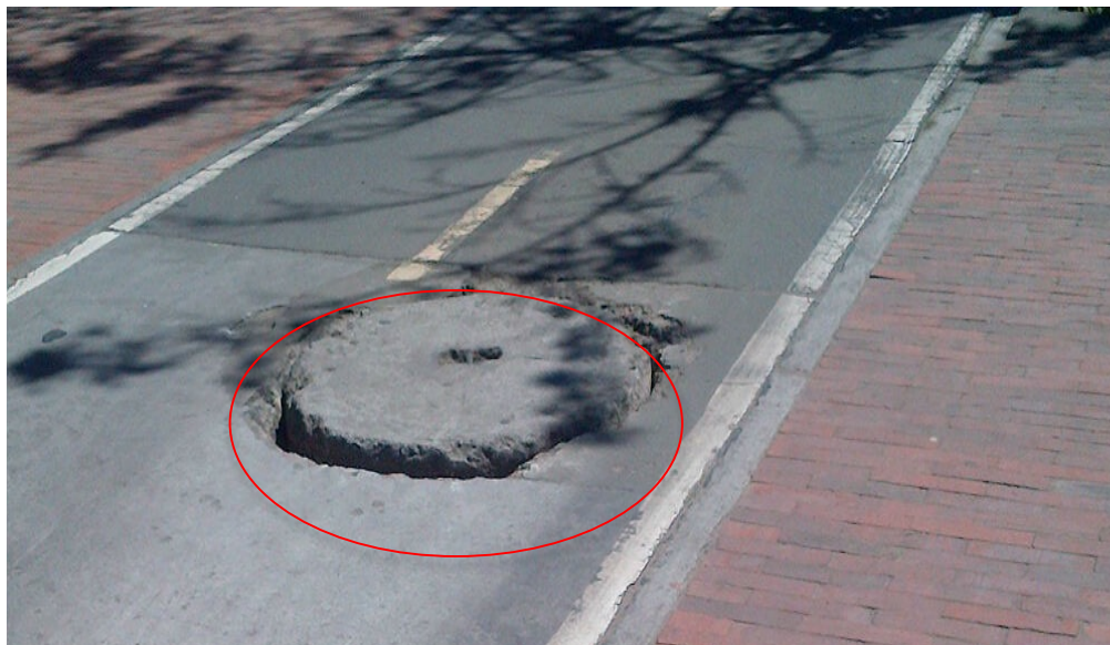
Imagen 76. Cajas de servicio público en ciclorruta Av. Boyacá
