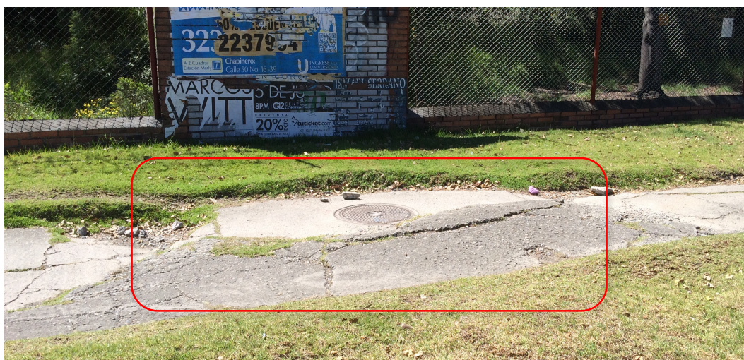
Imagen 66. Andén con deficiente superficie. Bavaria
