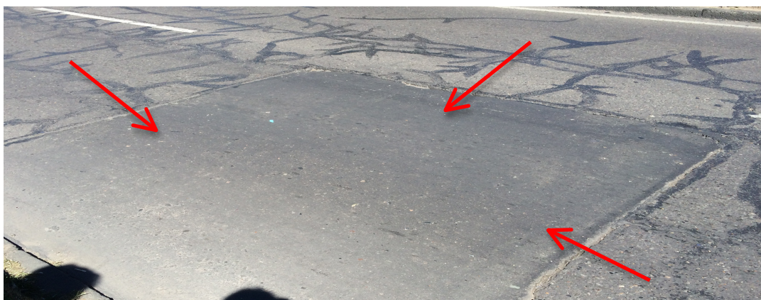
Imagen 50. Discontinuidad en pavimento. Av. Boyacá entre calle 13 y calle 12. Sur-norte
