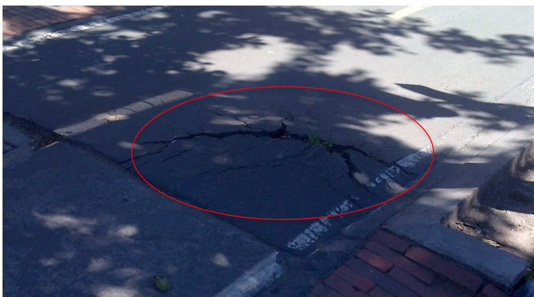
Imagen 75. Superficie levantada debido a raíces de arboles 2
