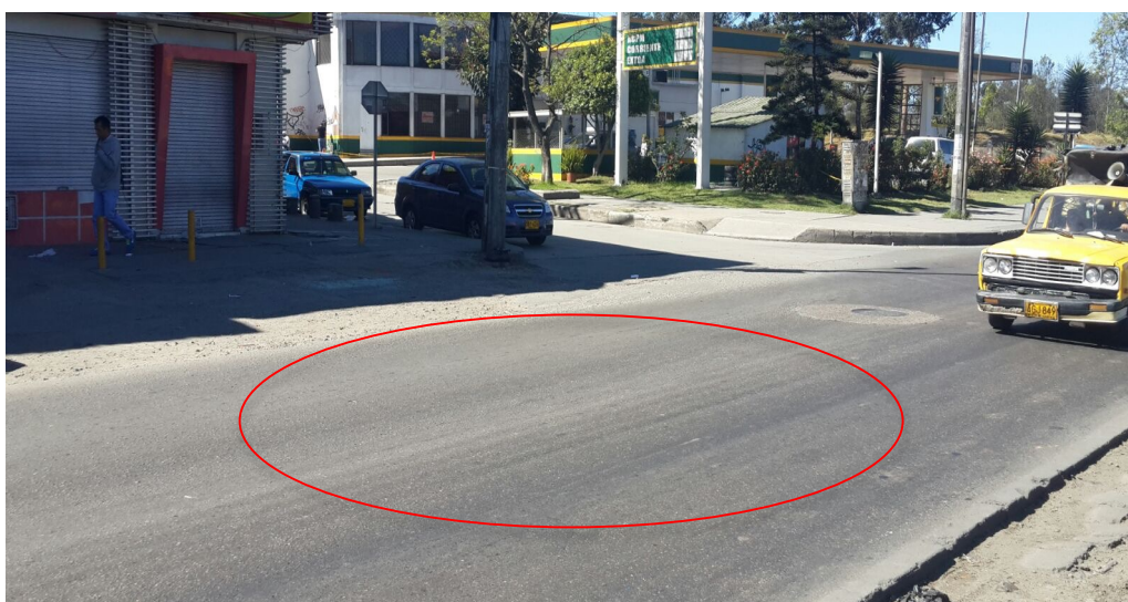
Imagen 47. Falta de demarcación de líneas separadoras de carril. Av. Boyacá con calle 12
