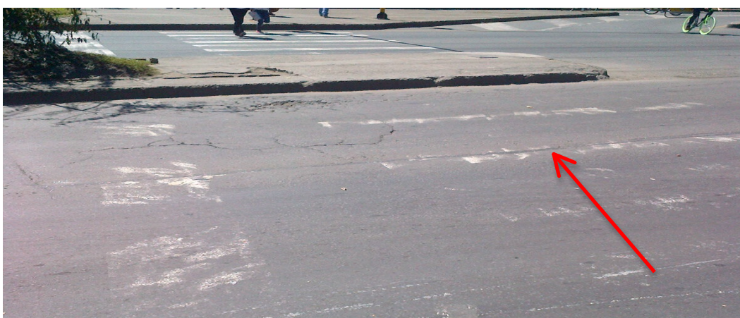
Imagen 46. Falta de demarcación peatonal. Av. Boyacá con Calle 8
