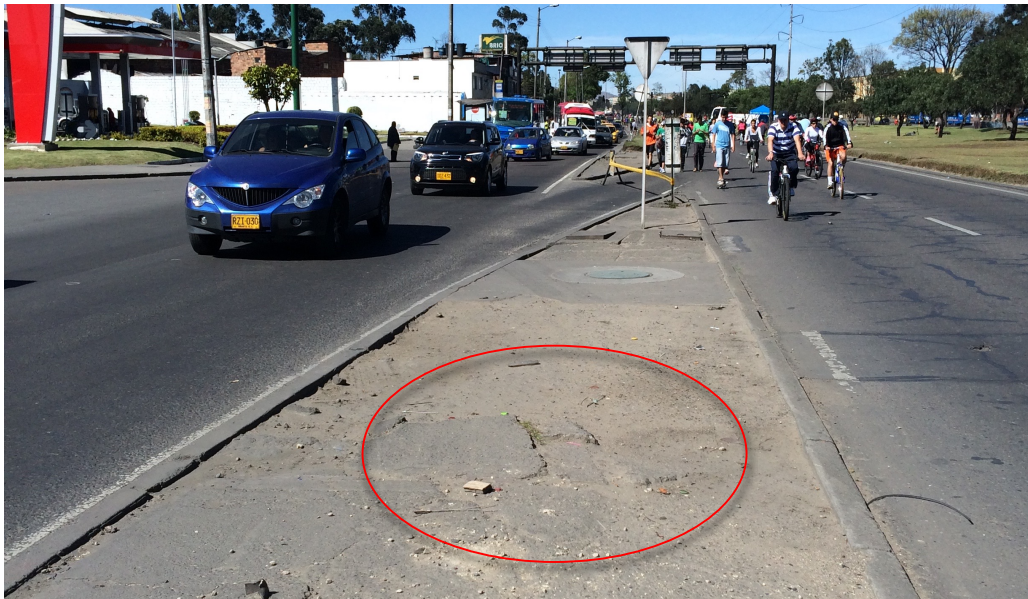
Imagen 61. Estado del separador Av. Boyacá con calle 12B
