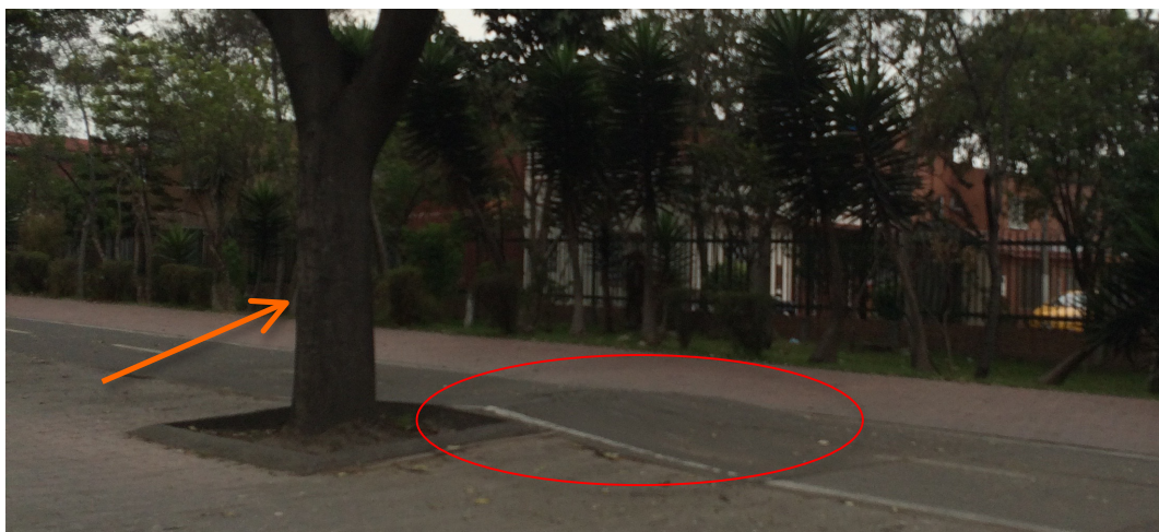
Imagen 74. Superficie levantada debido a raíces de arboles 1
