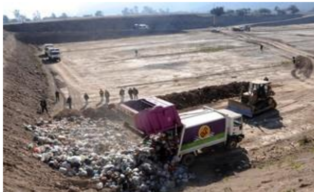
Imagen 3 Relleno sanitario en operación
