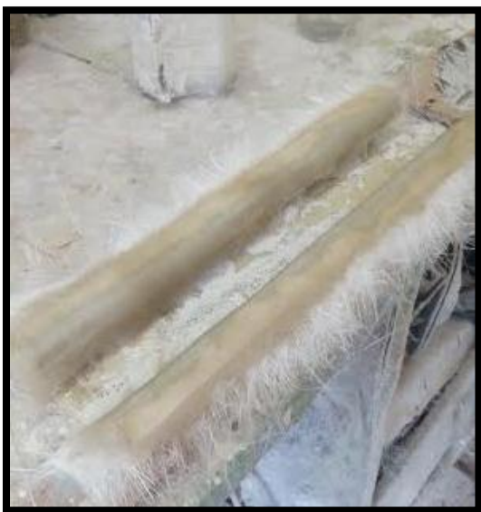
Imagen Número Trece: Aplicación de La fibra de vidrio sobre el molde.
