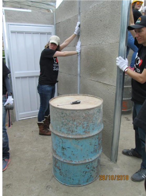
Figura 76. Personal Voluntario sosteniendo los muros sin amarres
