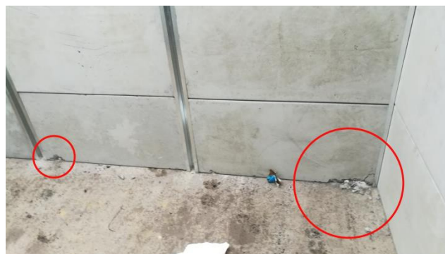
Figura 2. Roturas en esquinas de los paneles Elaboración propia.
