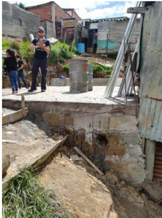
Figura 50. Terreno pendtado de difícil acceso, losa de cimentación. Componentes y materiales De la casa prefabricada. Fuente: Elaboración propia.
