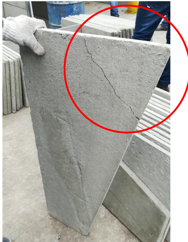
Figura 84. Grieta Panel Pizza. Fuentes: Elaboración propia.
