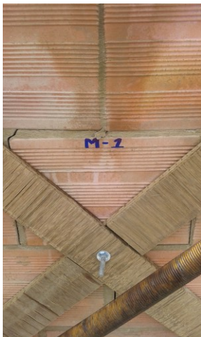
fallas de muretes
