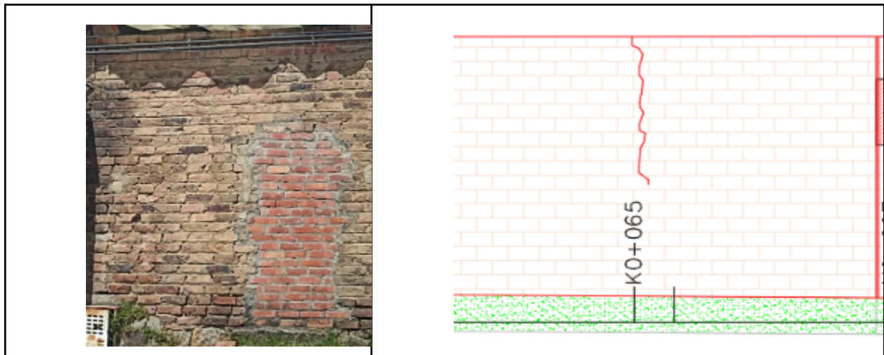
Ilustración 16 Patología identificada Muro 1
