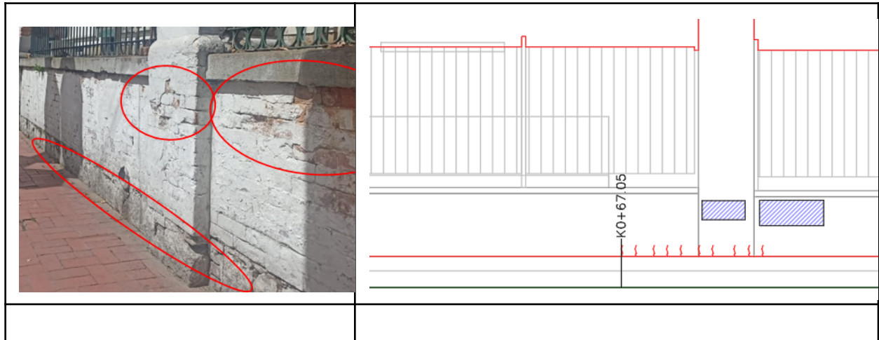
Ilustración 27 Patología identificada Muro 2
