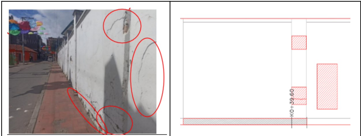
Ilustración 24 Patología identificada Muro 1
