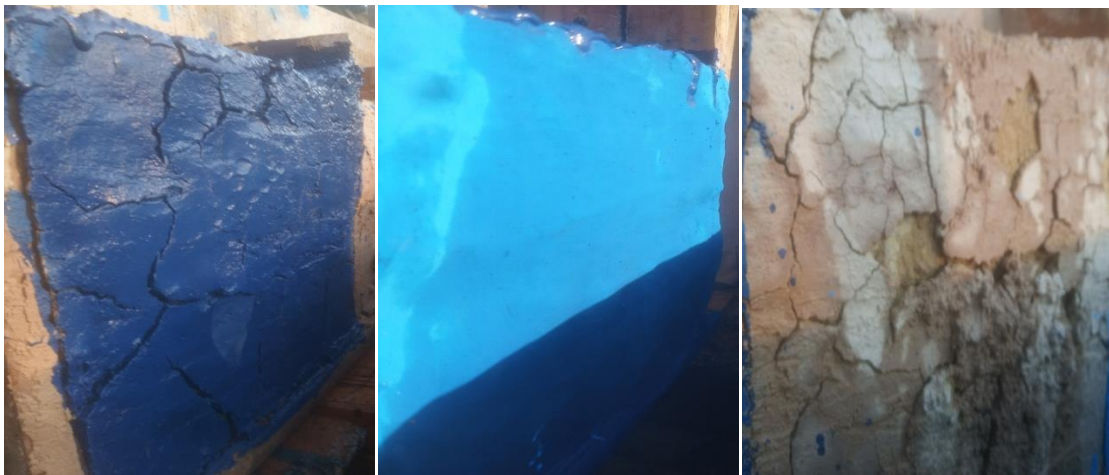
Figura 15. Filtración de agua en muretes. Elaboración propia.
