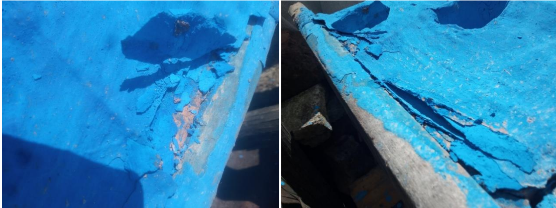
Figura 19. Falencias en la pintura por falta de ingredientes izquierda y a la derecha la proporción de la mezcla no tiene una consistencia adecuada ya que no hay balance en sus componentes. Elaboración propia.
