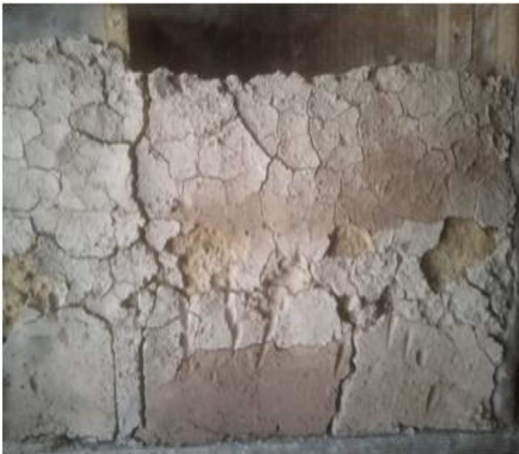
Figura 11. Muretes con problemas de fisuración por poca reparación y adecuación. Elaboración propia.
