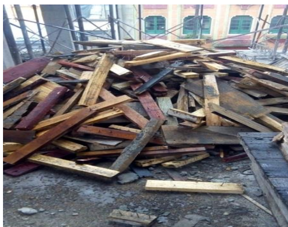
Figura 4 desperdicio de material de formaleta
