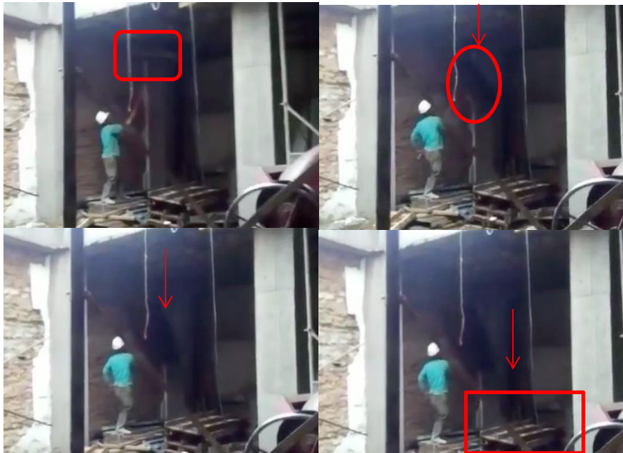
Figura 10 Secuencia del retiro incorrecto de la formaleta
