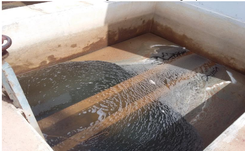
Fotografía 22. Estructura vista exterior agrietada, filtración de agua, presencia de musgo
