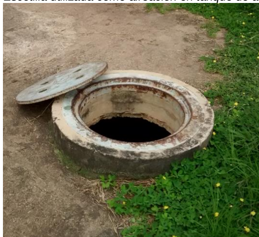
Fotografía 19. Escotilla utilizada como aireación en tanque de almacenamiento
