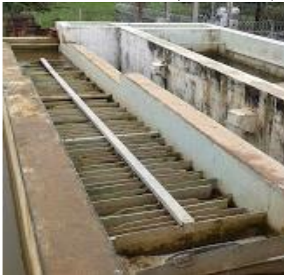
Fotografía 11. Floculador hidráulico de flujo horizontal en operación
