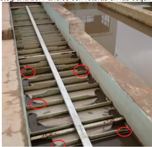
Fotografía 20. Paneles con roturas en las esquinas
