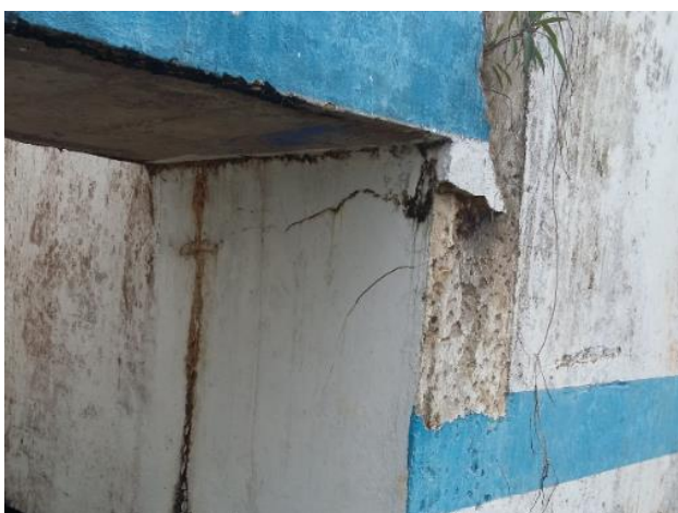
Fotografía 21. Estructura vista exterior agrietada, filtración de agua, presencia de musgo
