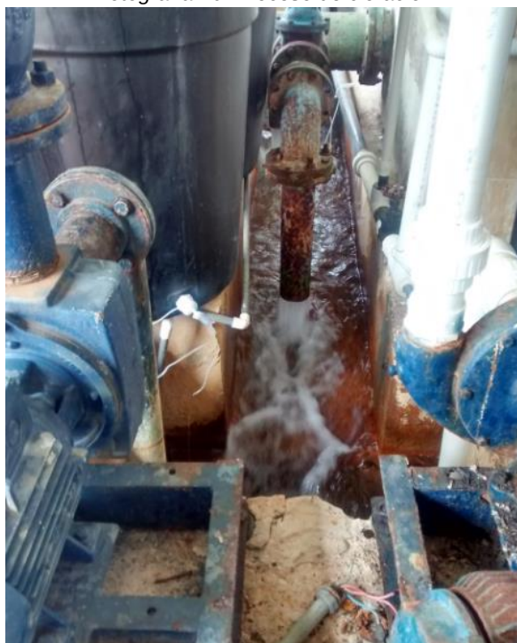
Fotografía 16. Proceso de cloración
