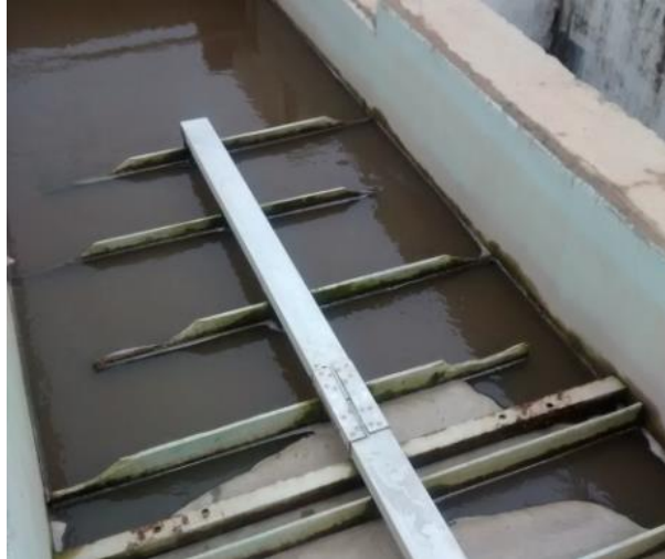
Fotografía 13. Tabiques con desgaste en la parte superficial permitiendo el flujo
