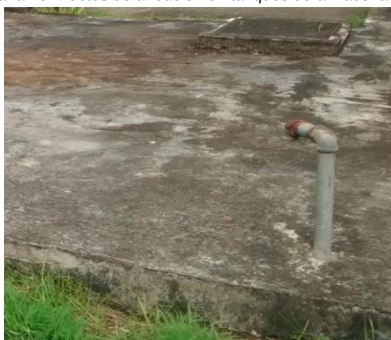
Fotografía 18. Ductos de aireación en tanques de almacenamiento
