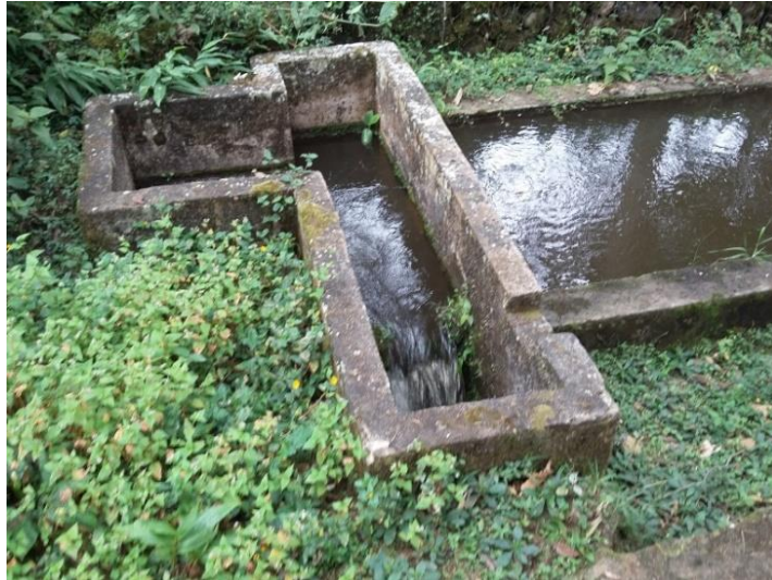
Fotografía 8. Canal de entrada y vertedero de excesos
