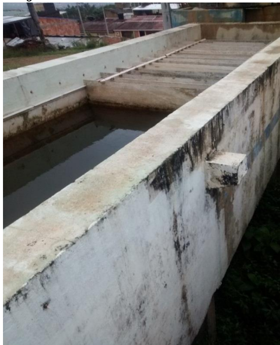
Fotografía 12. Floculador hidráulico fuera de servicio
