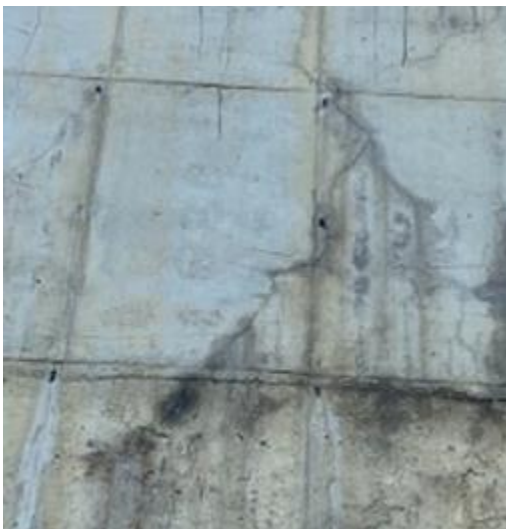
Fisuras en el muro 23 D
