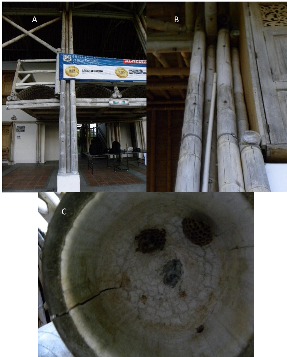
Imagen 47 Patologías encontradas en el pórtico 29 módulo C
