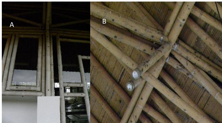
Imagen 37 Patologías encontradas en el pórtico 20 módulo B
