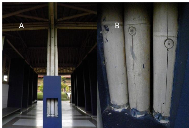
Imagen 34 Patologías encontradas en el pórtico 17 módulo A
