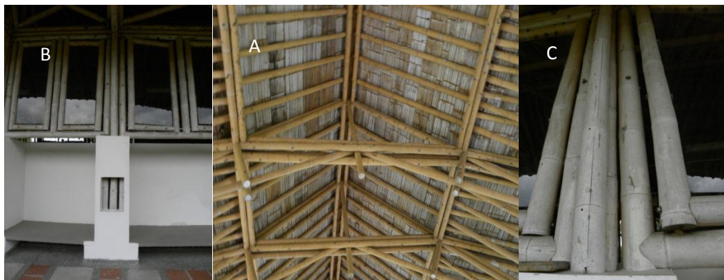
Imagen 25 Patologías encontradas en el pórtico 8 módulo A
