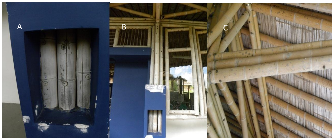
Imagen 28 Patologías encontradas en el pórtico 11 módulo A
