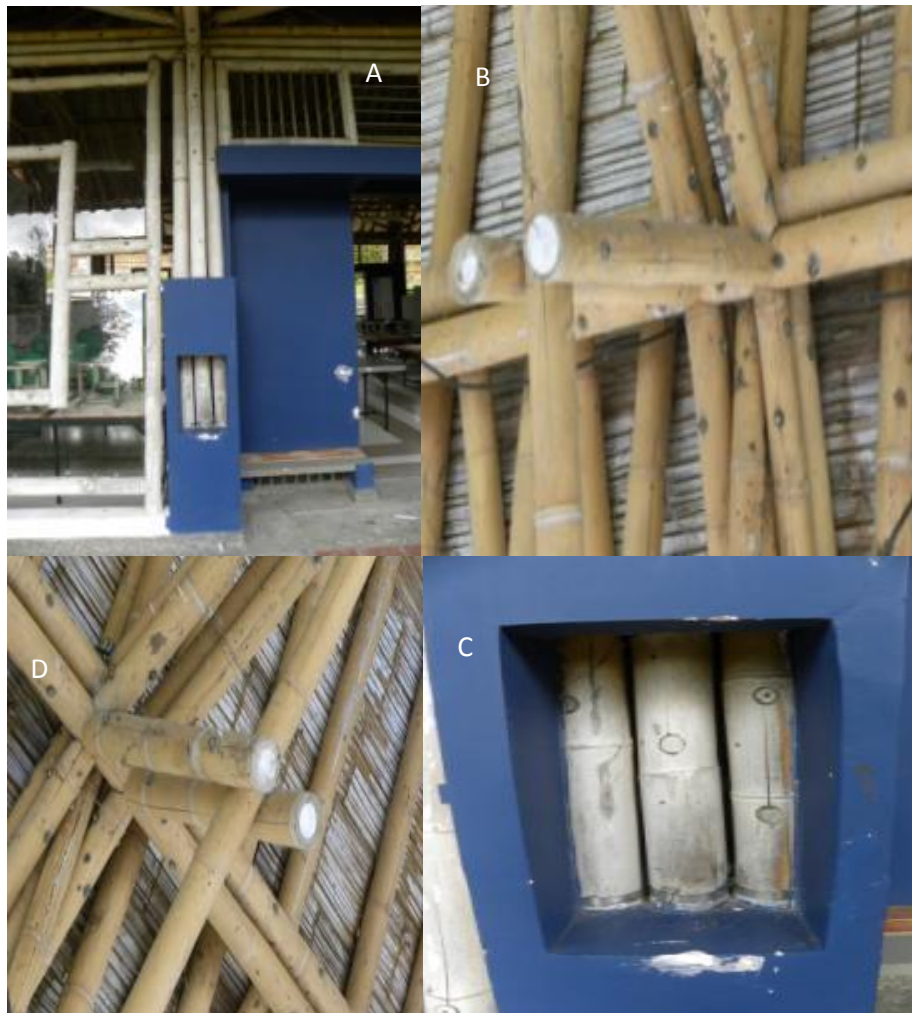
Imagen 30 Patologías encontradas en el pórtico 13 módulo A
