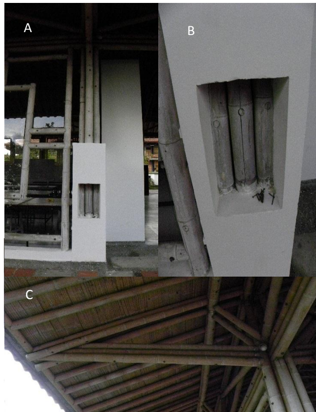
Imagen 35 Patologías encontradas en el pórtico 18 módulo B
