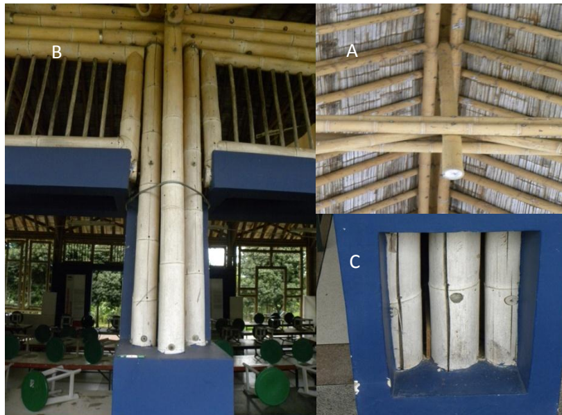
Imagen 29 Patologías encontradas en el pórtico 12 módulo A
