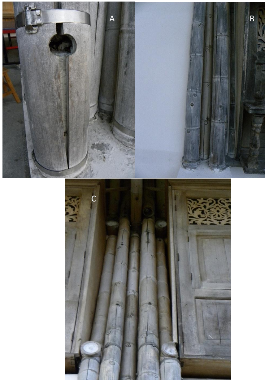
Imagen 46 Patologías encontradas en el pórtico 28 módulo C
