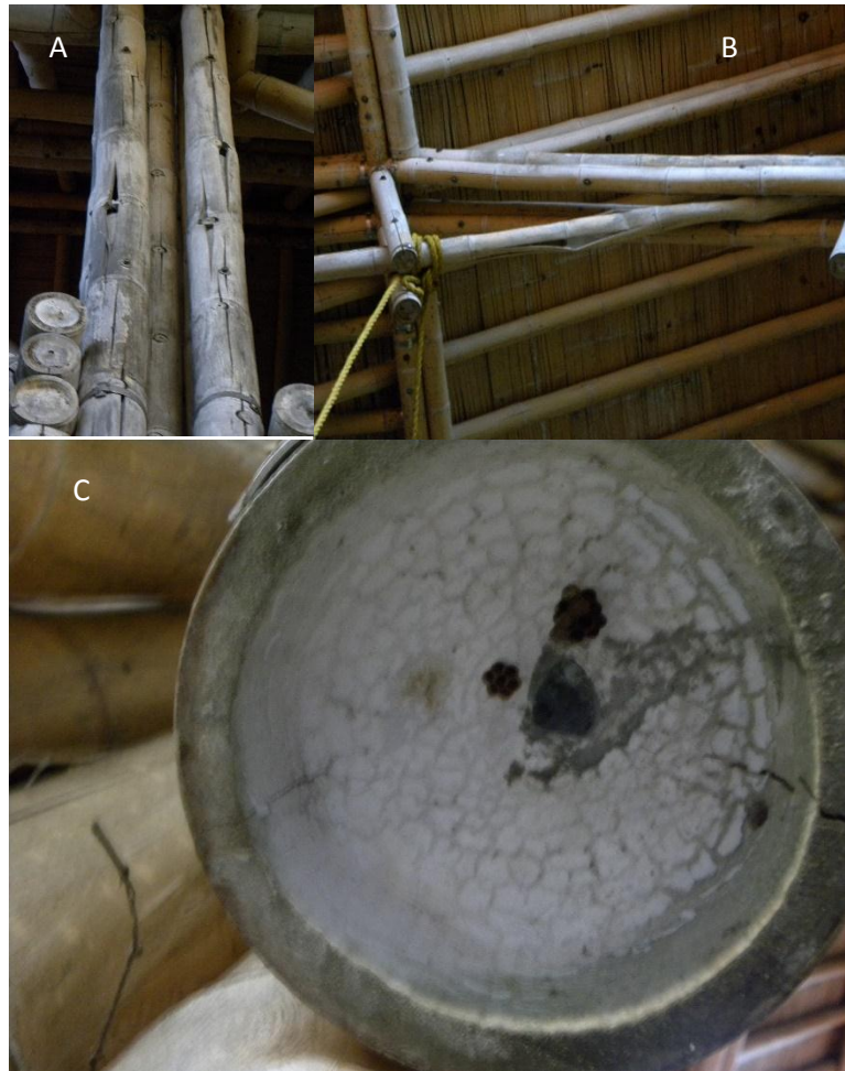
Imagen 45 Patologías encontradas en el pórtico 27 módulo C
