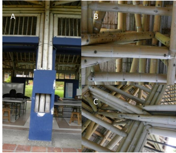
Imagen 20 Patologías encontradas en el pórtico 3 módulo A
