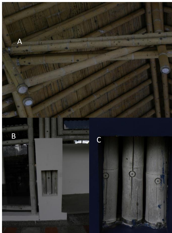
Imagen 41 Patologías encontradas en el pórtico 24 módulo B
