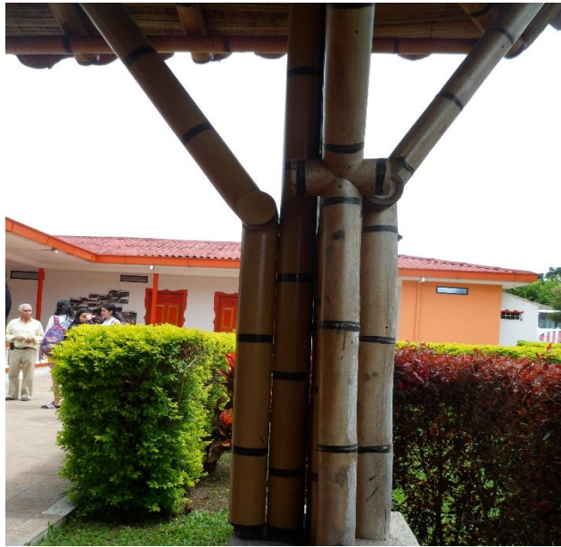
Imagen 57 Estructura en Guadua que presenta foto-degradación, con refuerzo de elementos de cobre.
