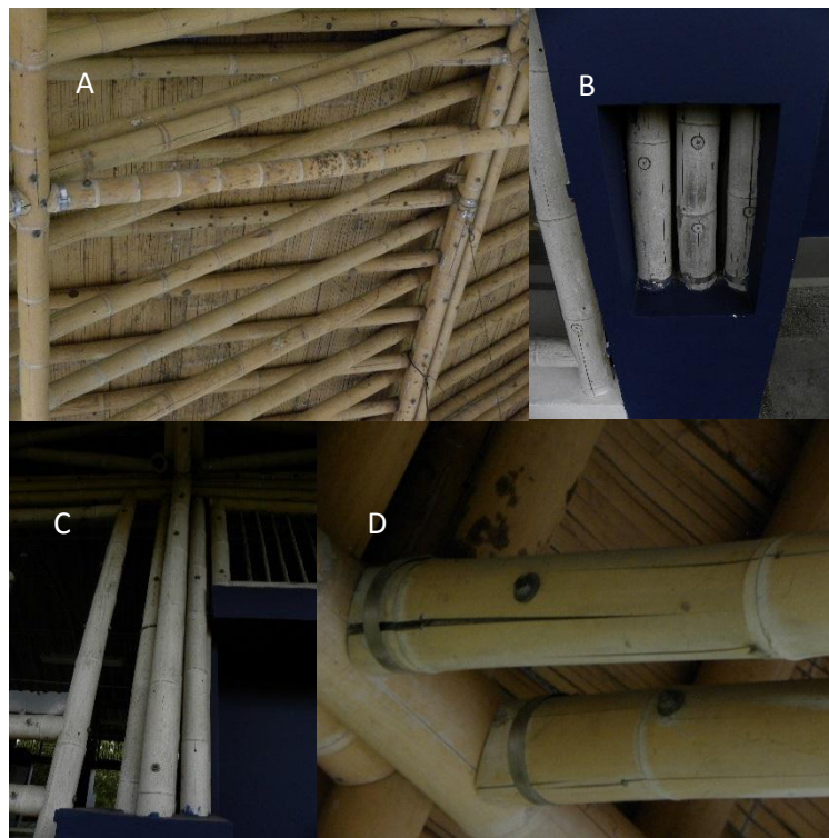
Imagen 38 Patologías encontradas en el pórtico 21 módulo B
