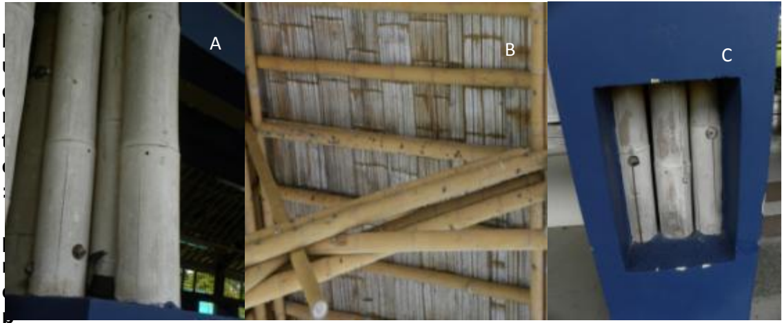
Imagen 24 Patologías encontradas en el pórtico 7 módulo A
