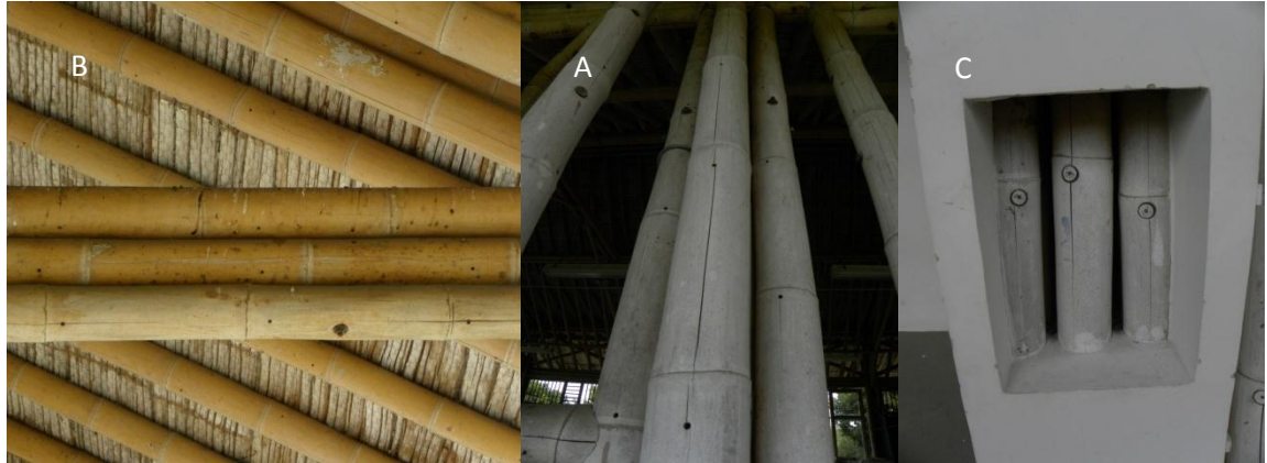
Imagen 22 Patologías encontradas en el pórtico 5 módulo A
