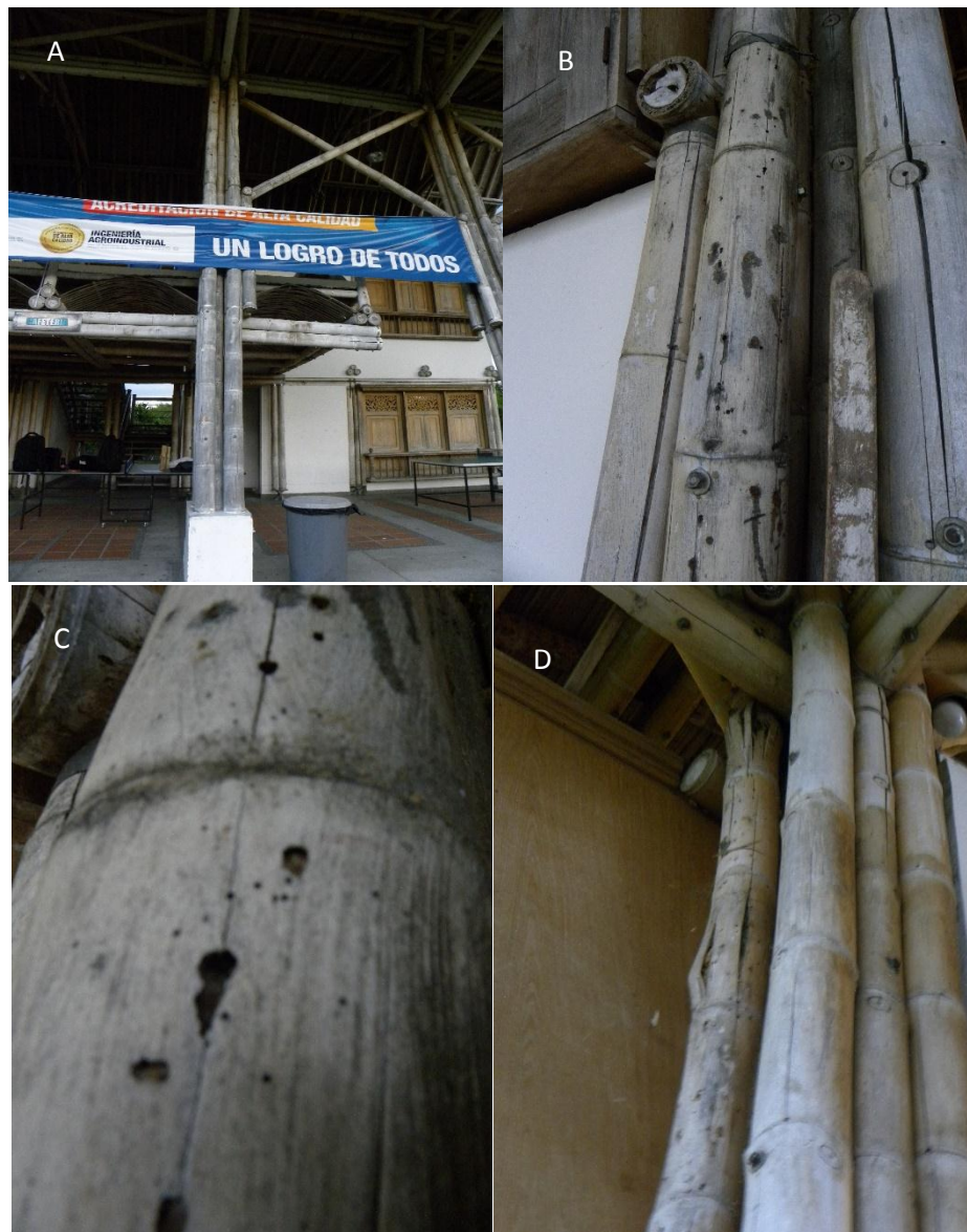
Imagen 48 Patologías encontradas en el pórtico 30 módulo C
