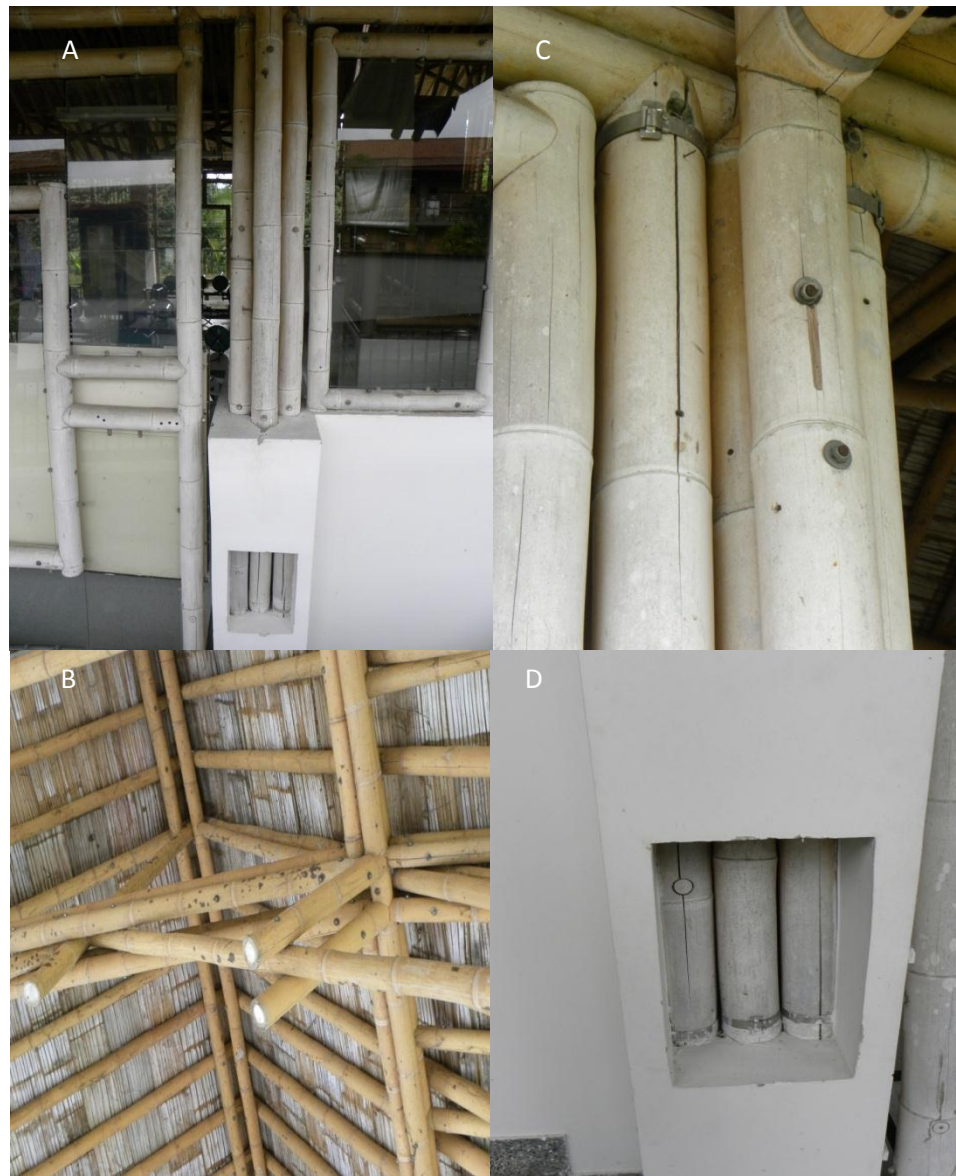
Imagen 31 Patologías encontradas en el pórtico 14 módulo A
