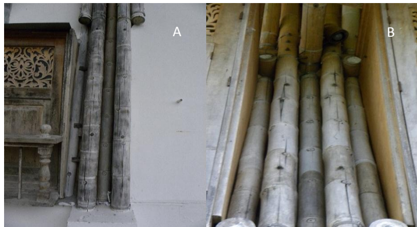
Imagen 49 Patologías encontradas en el pórtico 31 módulo C
