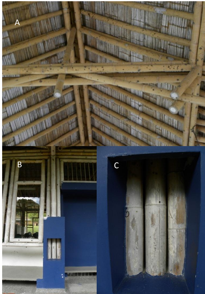
Imagen 26 Patologías encontradas en el pórtico 9 módulo A
