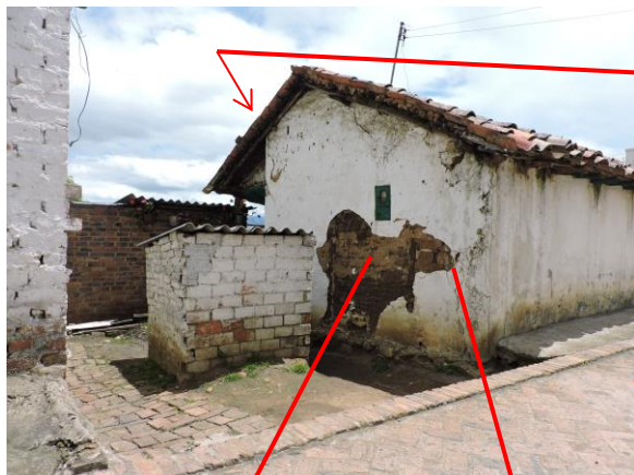
Imagen 26. pérdida de revocos de cal y arena.
