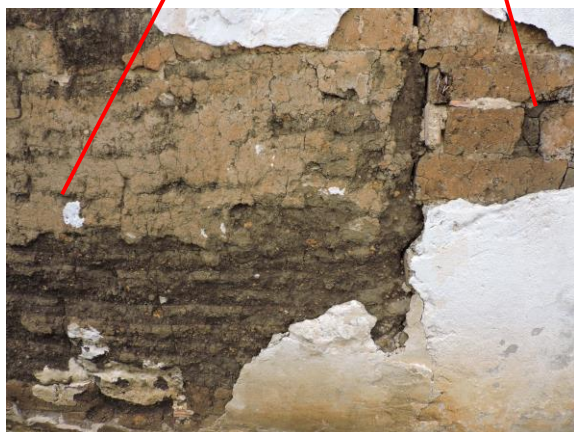
Imagen 28. falta de mantenimiento preventivo a causa de la falta de recursos económicos. Fuente propia.
