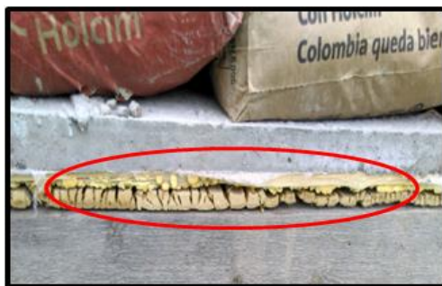
Fig.34: Falla de adhesivo poliuretano de la guadua laminada Fuente: Elaboración propia (2017).
