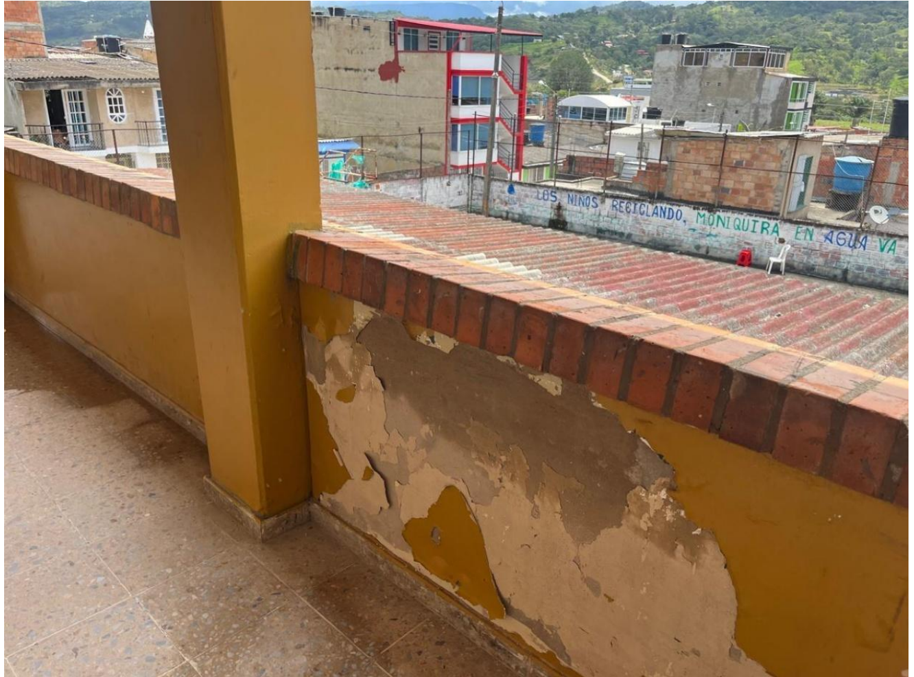
Figura 23 Presencia de Humedad en la sede Actual
