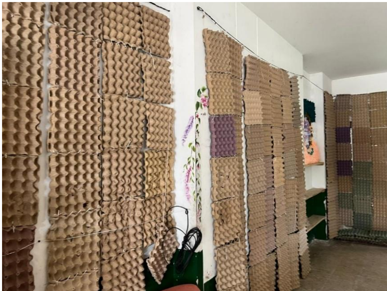
Figura 21 Carencias de Adecuación Acústica
