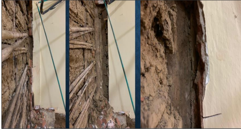
IMAGEN 28 tomada informe inspección visual ingeniero estructural
