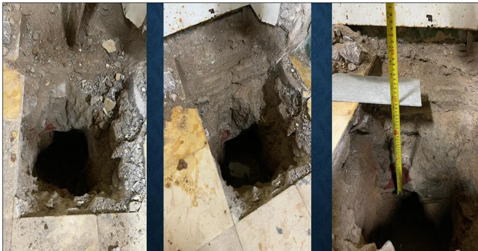
IMAGEN 21 tomada informe inspección visual ingeniero estructural
