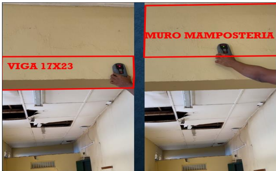
IMAGEN 32 tomada informe inspección visual ingeniero estructural
