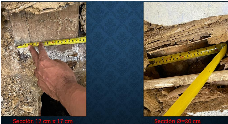
IMAGEN 19 tomada informe inspección visual ingeniero estructural
