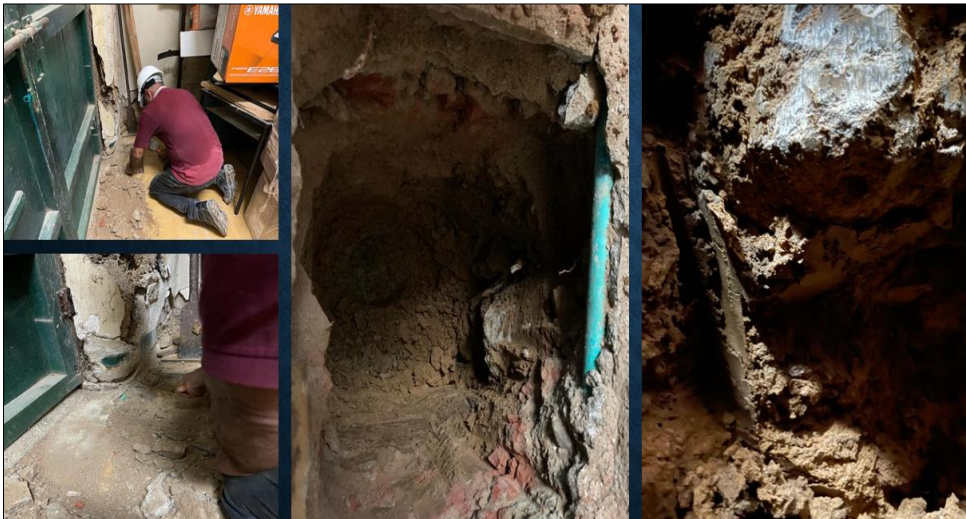
IMAGEN 20 tomada informe inspección visual ingeniero estructural
