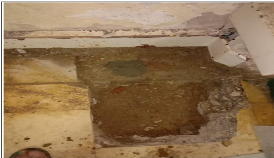
IMAGEN 39 tomada informe inspección visual ingeniero estructural
