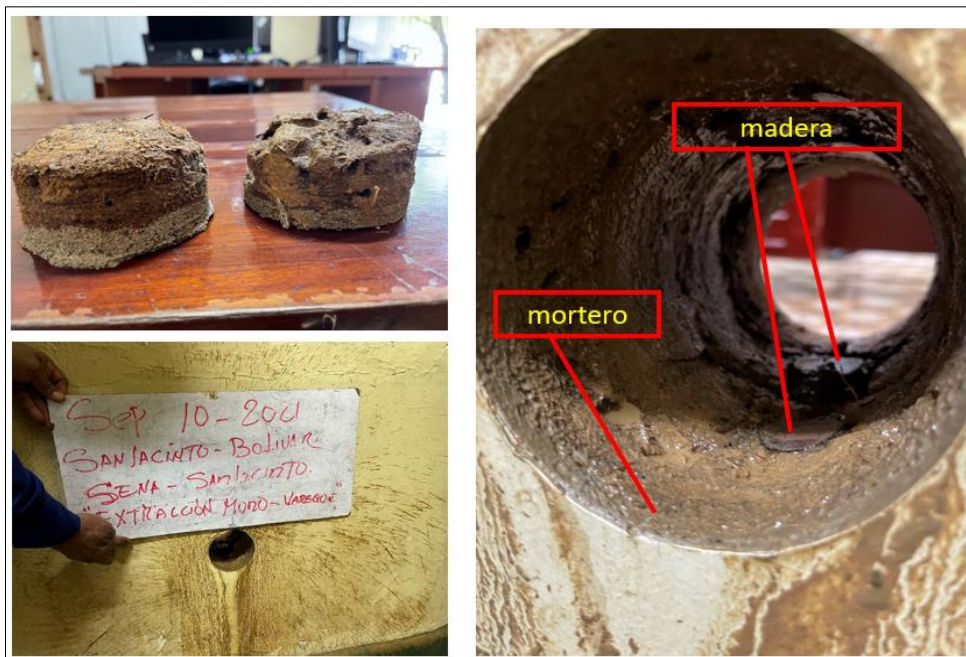
IMAGEN 45 tomada informe inspección visual ingeniero estructural
