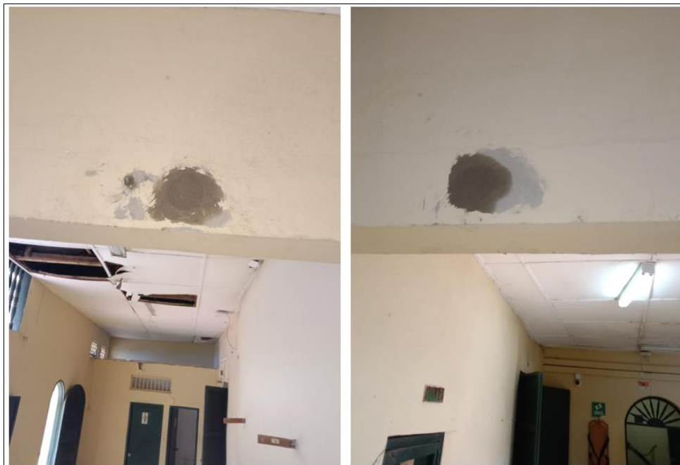
IMAGEN 42 tomada informe inspección visual ingeniero estructural
