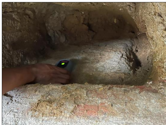
IMAGEN 29 tomada informe inspección visual ingeniero estructural
