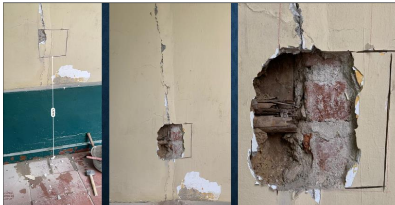
IMAGEN 27 tomada informe inspección visual ingeniero estructural
