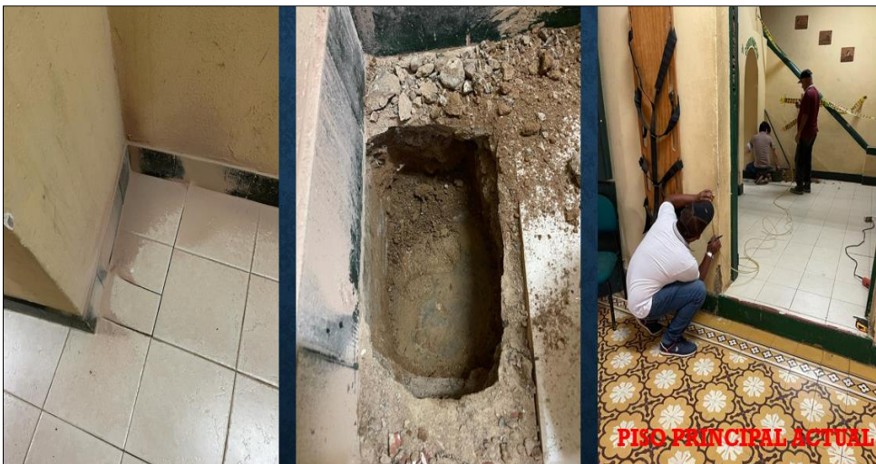
IMAGEN 23 tomada informe inspección visual ingeniero estructural
