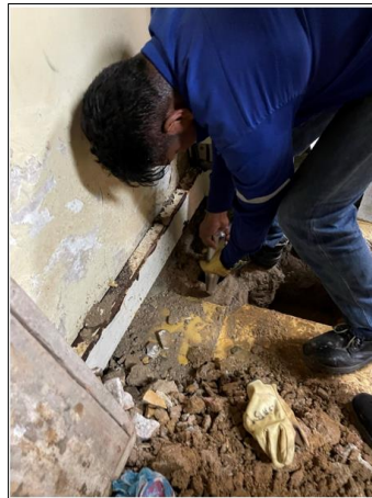
IMAGEN 33 tomada informe inspección visual ingeniero estructural
