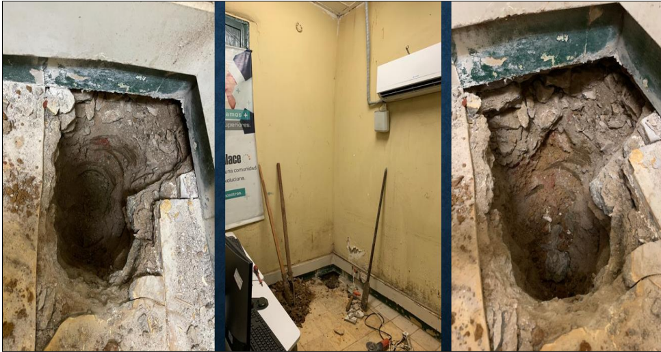
IMAGEN 22 tomada informe inspección visual ingeniero estructural
