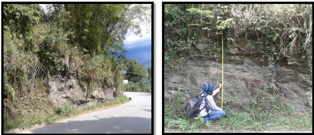
Imagen 3. Inclinación de los árboles y pérdida de cobertura vegetal.
