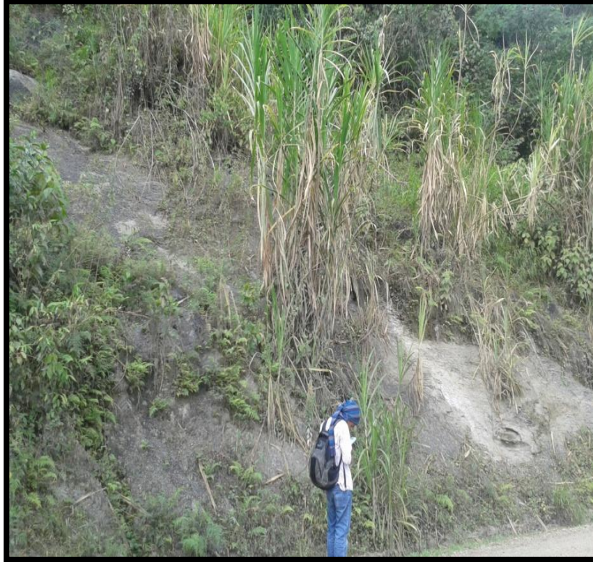
Imagen 9. Perdida de la capa vegetal y flujo de material.
