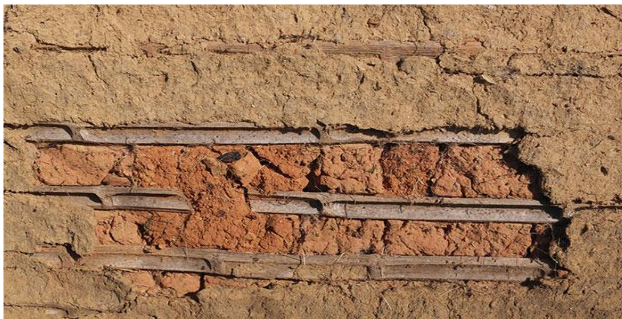
Figura 11 Pañete bahareque embutido en tierra. La ilustración expone un muro embutido en tierra el cual evidencia un desprendimiento mostrando la estructura interna, esto debido a la humedad y la falta de resistencia ante la intemperie, Tomado de “características y patologías constructivas del Bahareque tradicional en la vereda san pedro de del municipio de Anserma” Carlos (2018). Recuperado de www.carlosmunera.com
