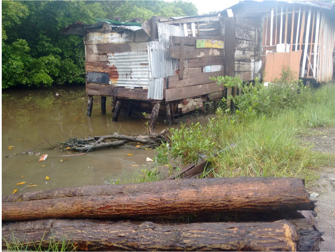
Figura 9 (Deterioro de vivienda Barrio Pescadores Elaboración Propia)
