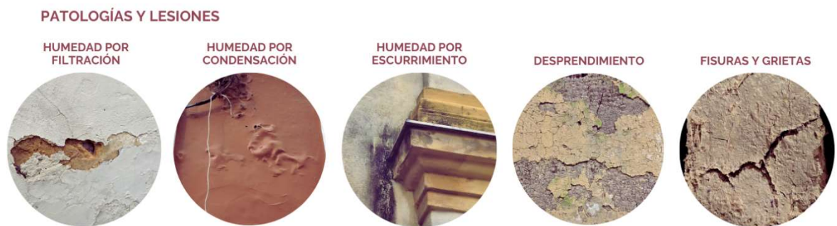
Figura 4 Patologías y lesiones
