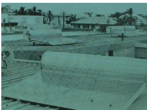
Ilustración 26 Calentador solar corriente en Australia.
