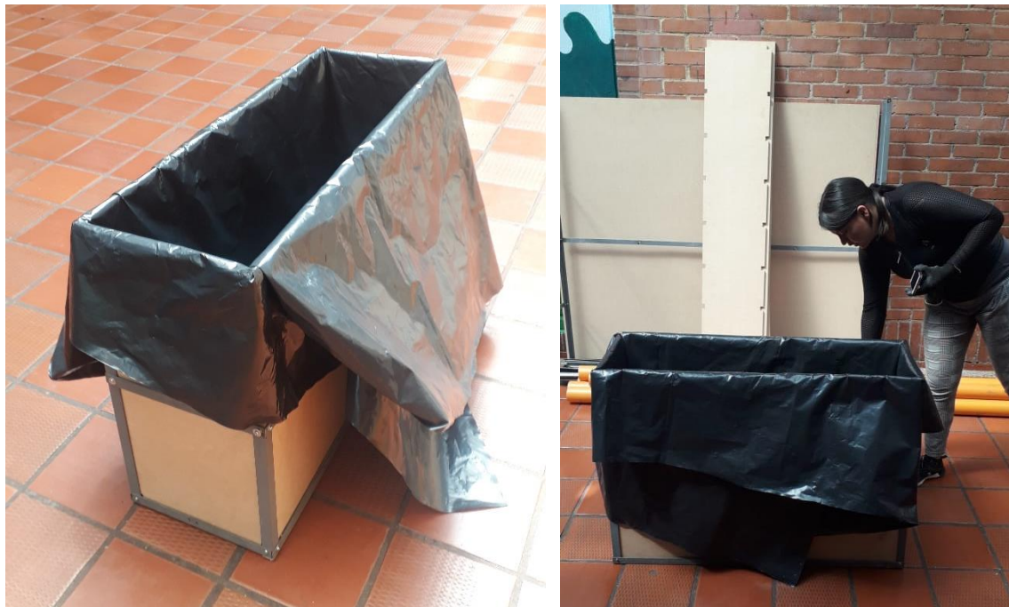
Figura 39. Parte interior del tanque, plástico calibre 8 Fuente: elaboración propia
