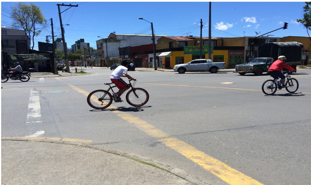
(demarcación horizontal deficiente)
