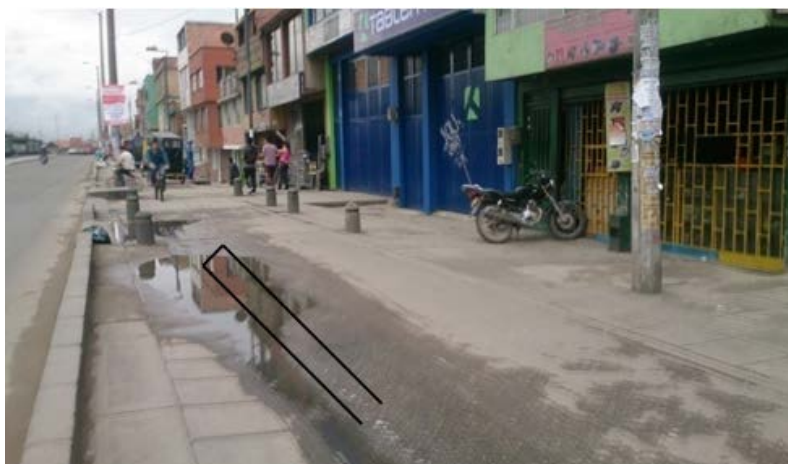
IMAGEN 26 Deterioro en la demarcacion longitudinal tramo N°1
