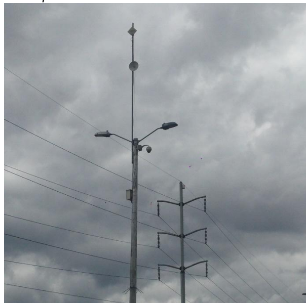
Figura 23 Cámara de Fotocompareando instalada
