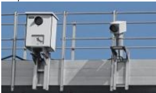
Figura 8 Cámaras y Radares en pórtico.
