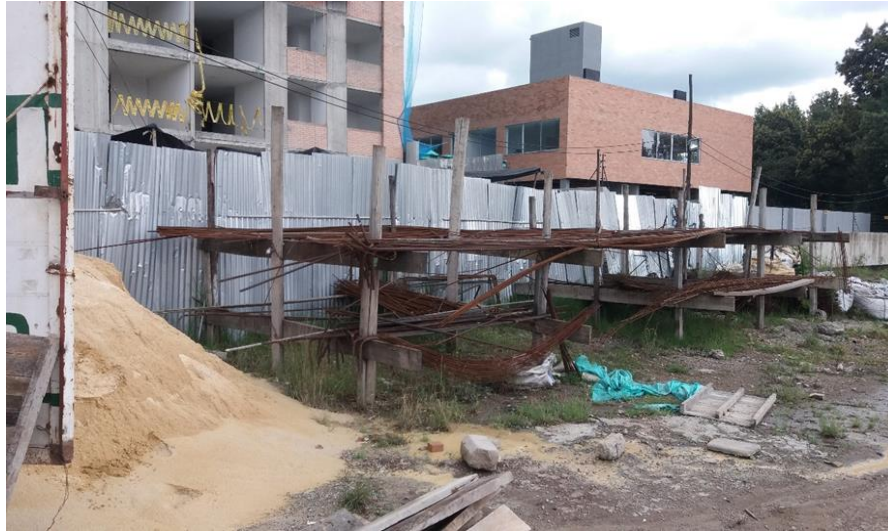
Ilustración 3 Proyecto bosques de tulipanes. Evidencia de mal manejo de materiales. Fuente propia.
