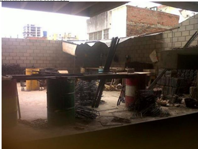
Ilustración 8 El acero que se va a utilizar para armar la cimentación y columnas se encuentra almacenada dentro de la estructura, interfiriendo para la actividad de acabados. Tomado de “Estudio de la planificación del
