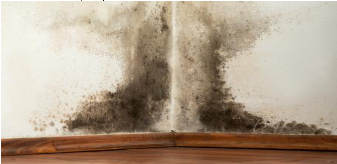
Ilustración 5 Humedad por capilaridad
