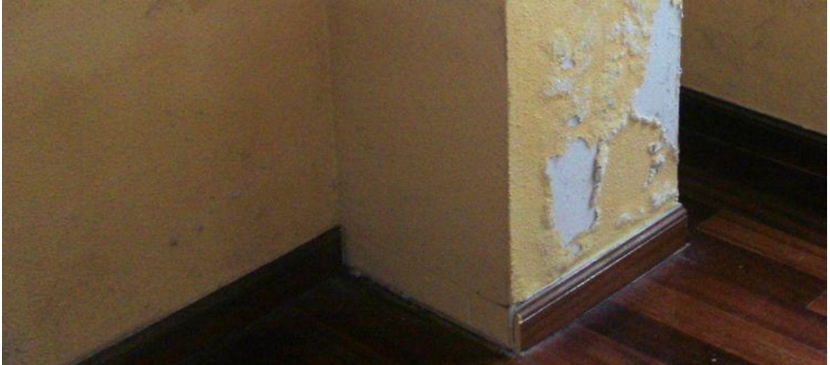
Ilustración 7 Caída de pintura por consecuencia de humedades
