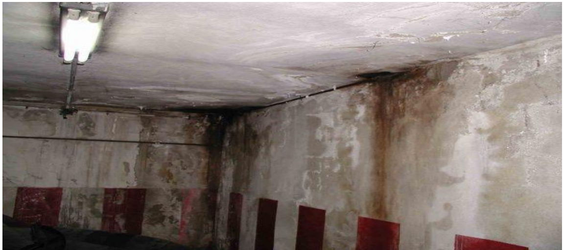
Ilustración 8 Manchas causadas por humedades
