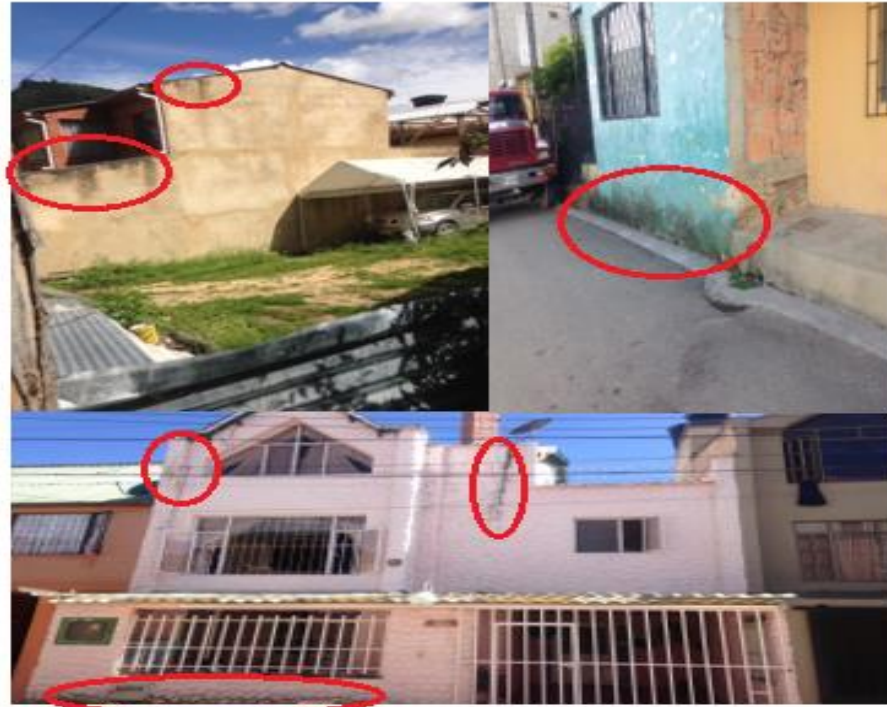
Ilustración 11 Humedades en fachadas
