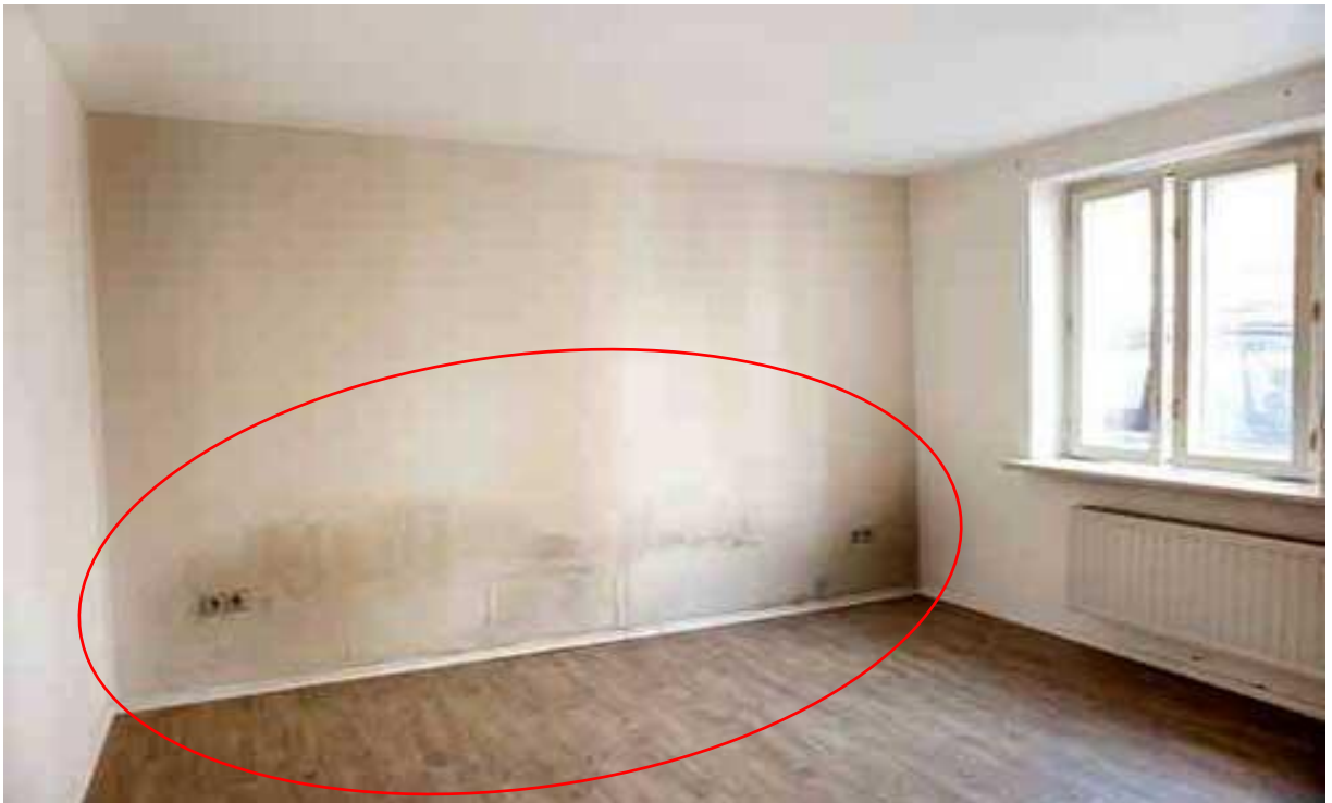
Ilustración 2 Humedad en casa
