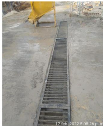
Cárcamos para recolección de aguas de lavado de llantas de volquetas
