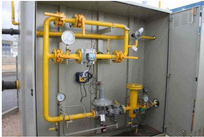
figura 1 Instalación de gas natural
