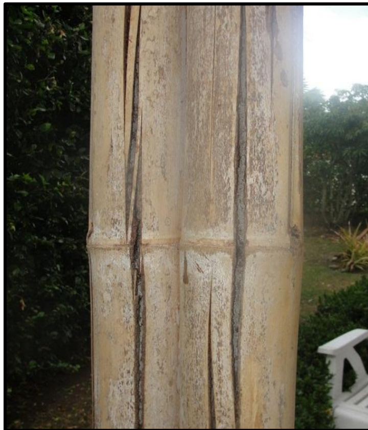
Figura 1. Afectación de la Guadua con Rajaduras y Fotodegradación en elemento estructural Casa Chinauta. Fuente Propia
