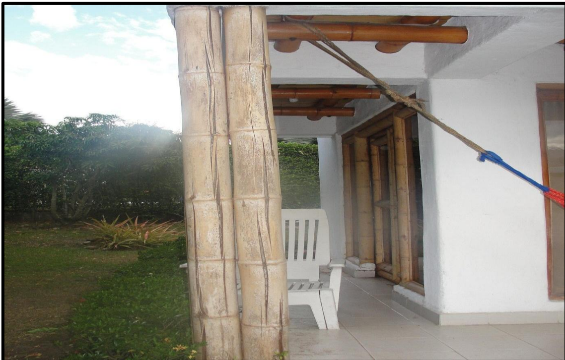
Figura 6. Daño Grave en Elemento Estructural por Fotodegradación Casa Chinauta. Fuente Propia.
