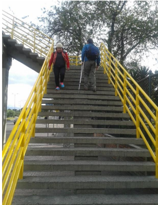
Ilustración 6. Escaleras (Dificultad para el tránsito peatonal).
