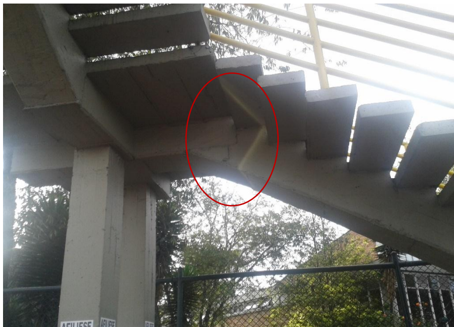
Ilustración 3. Grietas en conexiones de escaleras.
