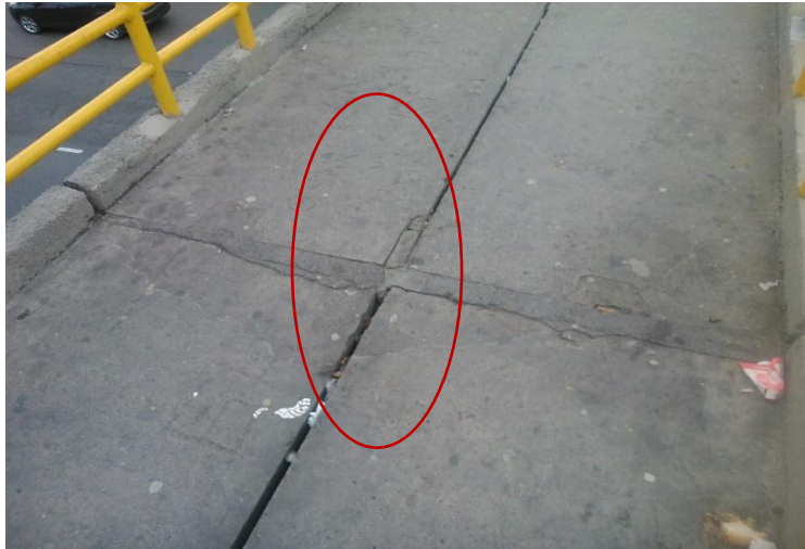
Ilustración 4. Deterioro en la losa de concreto.
