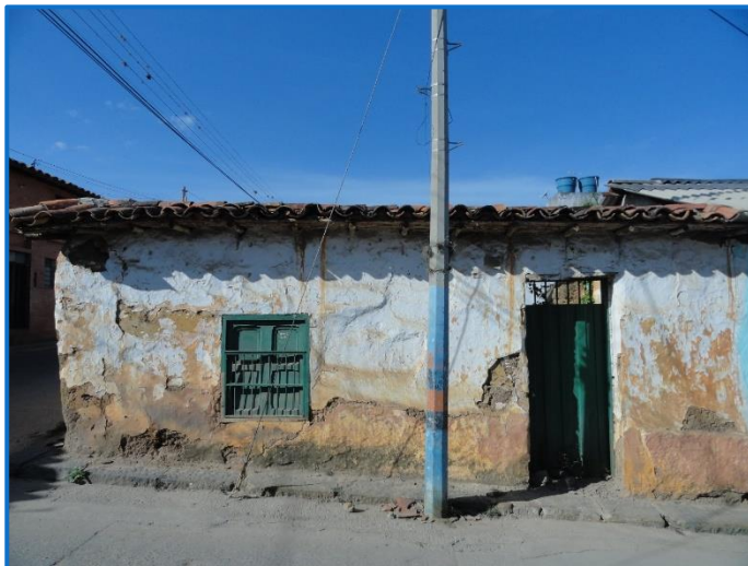
Imagen 81. Predio en estado de ruina Fuente: Propia
