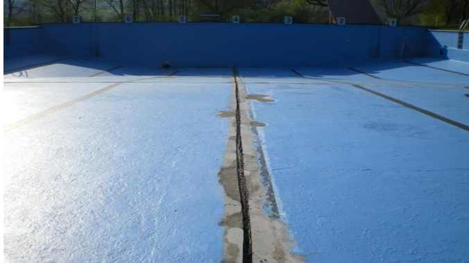
Foto 16. Juntas presentes en la superficie de una piscina
