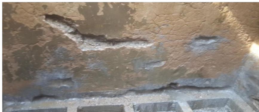
Foto 15. Hormigueros en muro de tanque.
