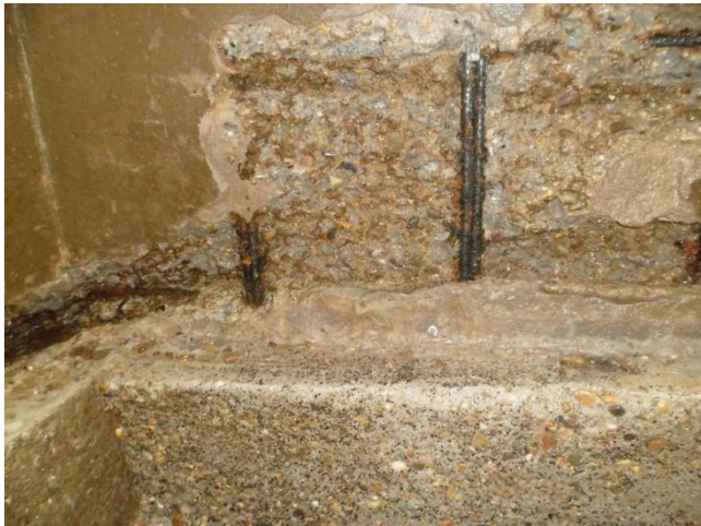
Foto 27. Abujardado en superficie de concreto
