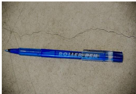
Foto 14. Fisuras en superficie de concreto
