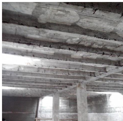
Foto 18. Superficie de tanque con ausencia de material impermeabilizante
