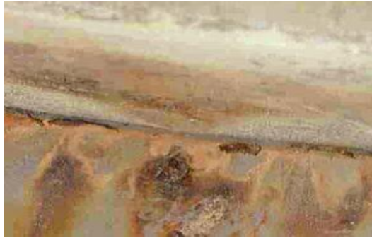
Foto 21. Corrosión en superficie de concreto
