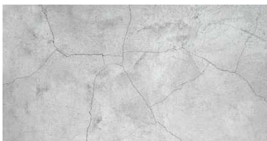
Foto 20. Fisuras en la superficie del concreto
