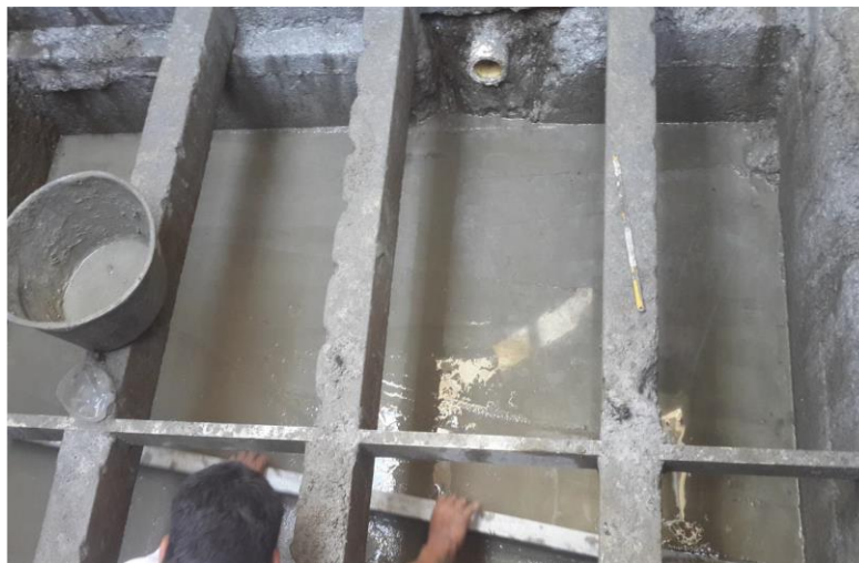
Foto 19. Infiltración de agua por nivel freático
