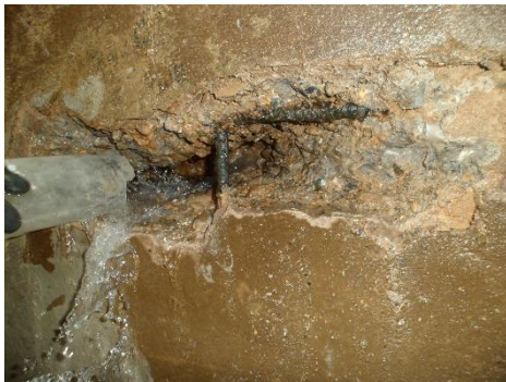
Foto 30. Infiltración de agua por nivel freático
