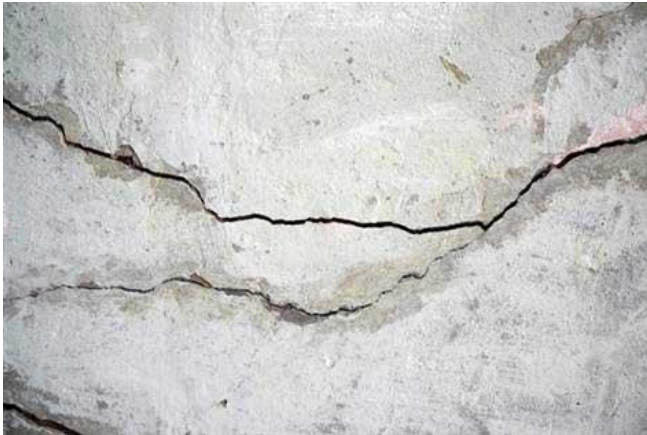
Foto 17. Grietas presentes en superficie de muro de concreto
