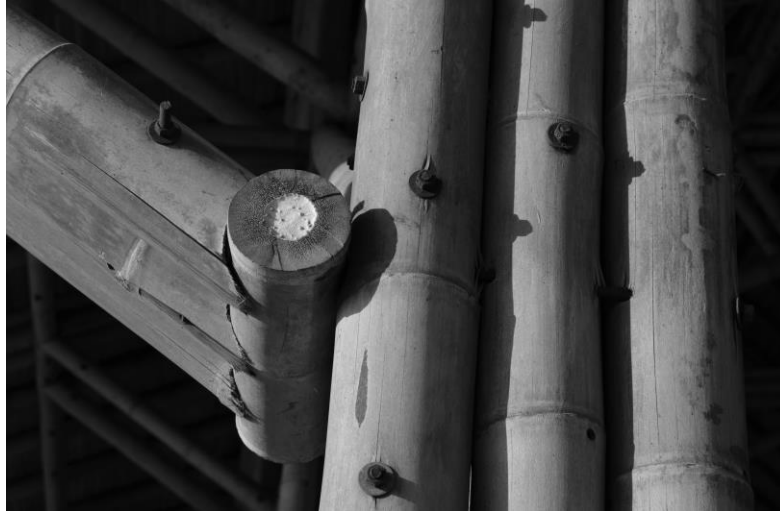
Figura 17. Oxidación en elementos metálicos de unión, fisuras en elementos verticales que sirven de apoyo a la cubierta. Fuente: Walter Barreto. Archivo personal.
