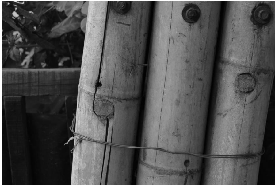
Figura 16. Grietas en base de pilares de guadua. Fuente: Walter Barreto. Archivo personal.
