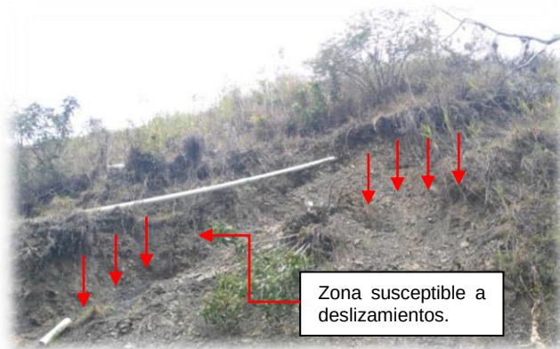
Figura 19. Deslizamientos sobre la línea de aducción al tanque de bombeo.
