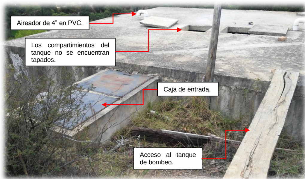
Figura 22. Tanque de bombeo.
