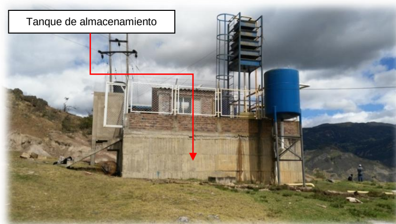
Figura 39. Tanque de almacenamiento.
