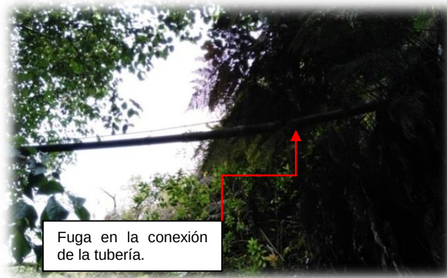
Figura 20. Paso elevado de la tubería.
