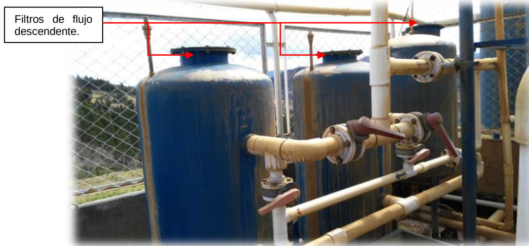
Figura 33. Filtros de la planta de tratamiento de agua potable convencional.
