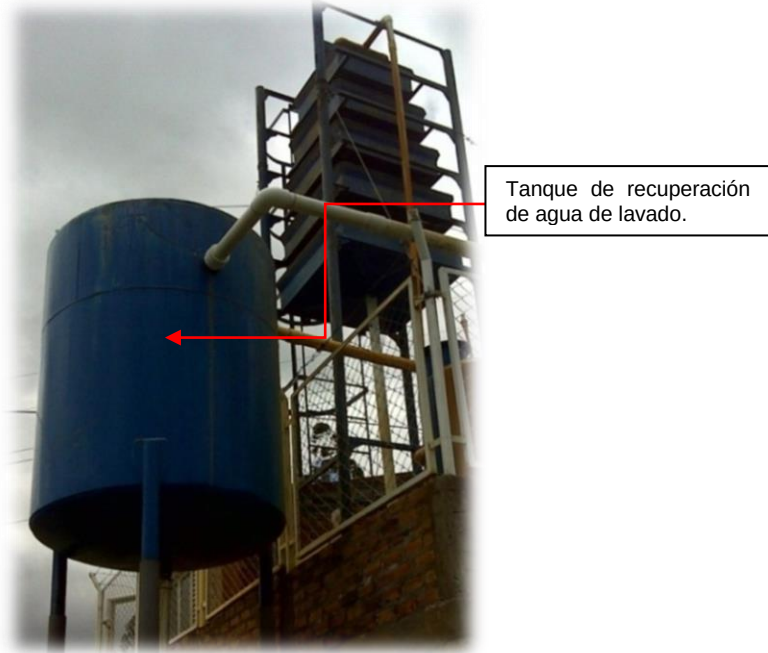
Figura 37. Tanque de recuperación de agua de lavado.
