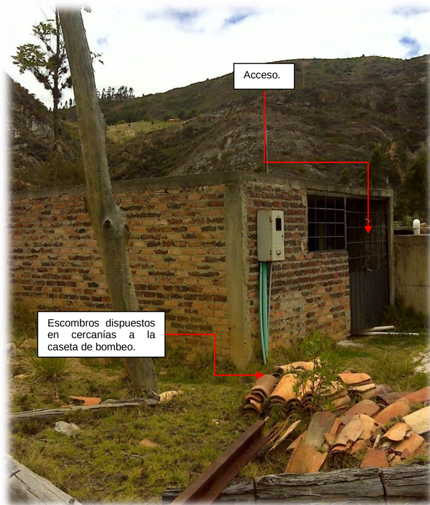
Figura 24. Estación de bombeo.
