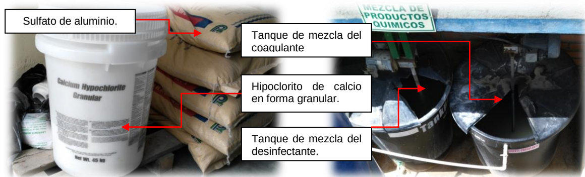
Figura 35. Químicos para los procesos de desinfección y coagulación (izquierda) y tanques de mezcla (derecha).
