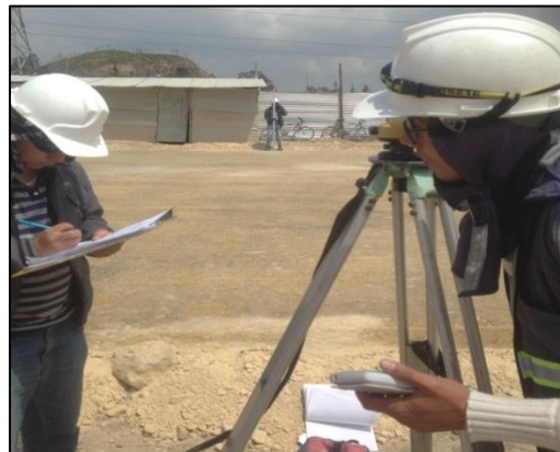
FIG 14 LIBERACIÓN DE CAPAS DE RECEBO B – 200 TERRAZAS POR EL EQUIPO DE TOPOGRAFÍA. INTERVENTORÍA Registro fotográfico de obra Giovanni Hernández inspector de interventoría vivienda
