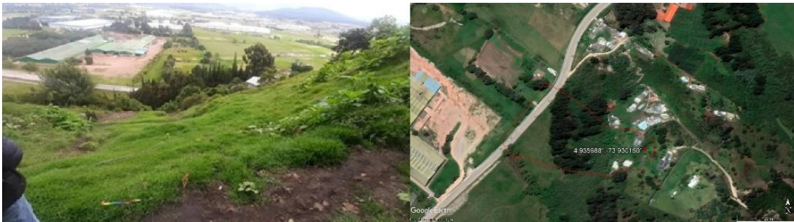
Figura 1-1. Asentamientos diferenciales en la ladera de la montaña. Fuente: Informe Técnico DGOAT No. 068 de 29 JUL. 2021.
