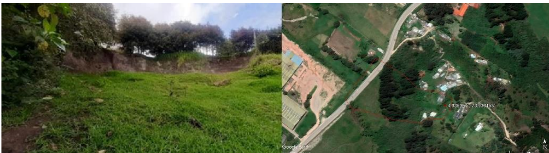
Figura 1-2. Vista afectación muro. Fuente: Informe Técnico DGOAT No. 068 de 29 JUL. 2021.
