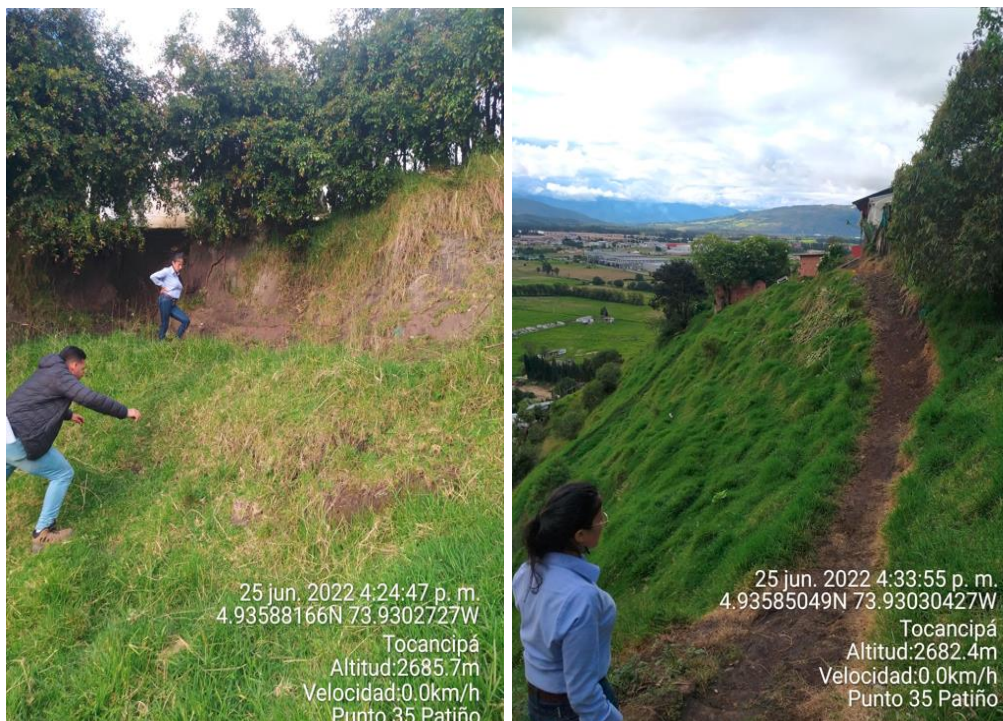
Figura 1-35. Procesos de inestabilidad presentes. Fuente: Propia.
