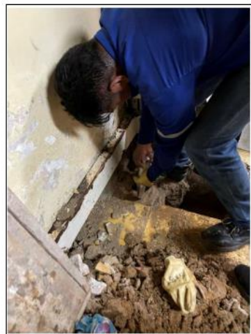
IMAGEN 33 tomada informe inspección visual ingeniero estructural
