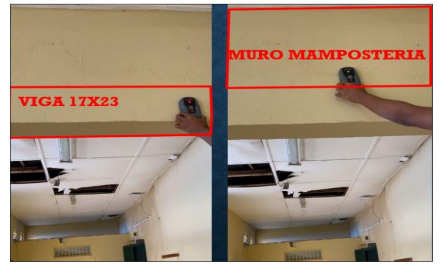
IMAGEN 32 tomada informe inspección visual ingeniero estructural
