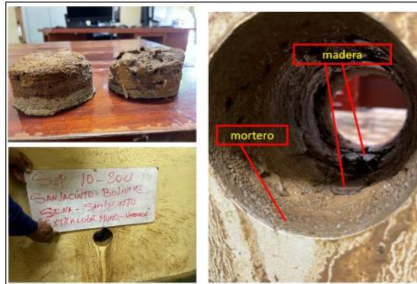
IMAGEN 45 tomada informe inspección visual ingeniero estructural
