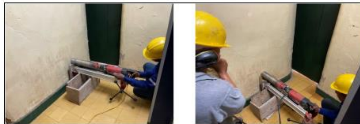
IMAGEN 44 tomada informe inspección visual ingeniero estructural
