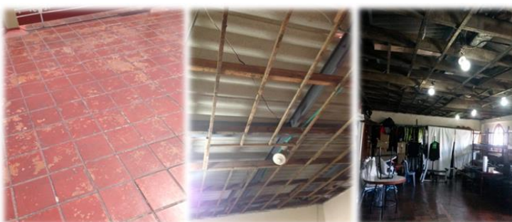
Ilustración 51 Estado actual del cuarto piso y patologías.
