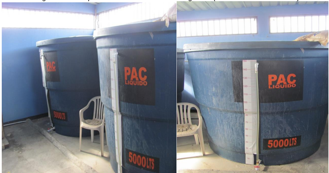
Fotografía 12. Tanques de almacenamiento del coagulante (Hidroxiclورو de Aluminio).
