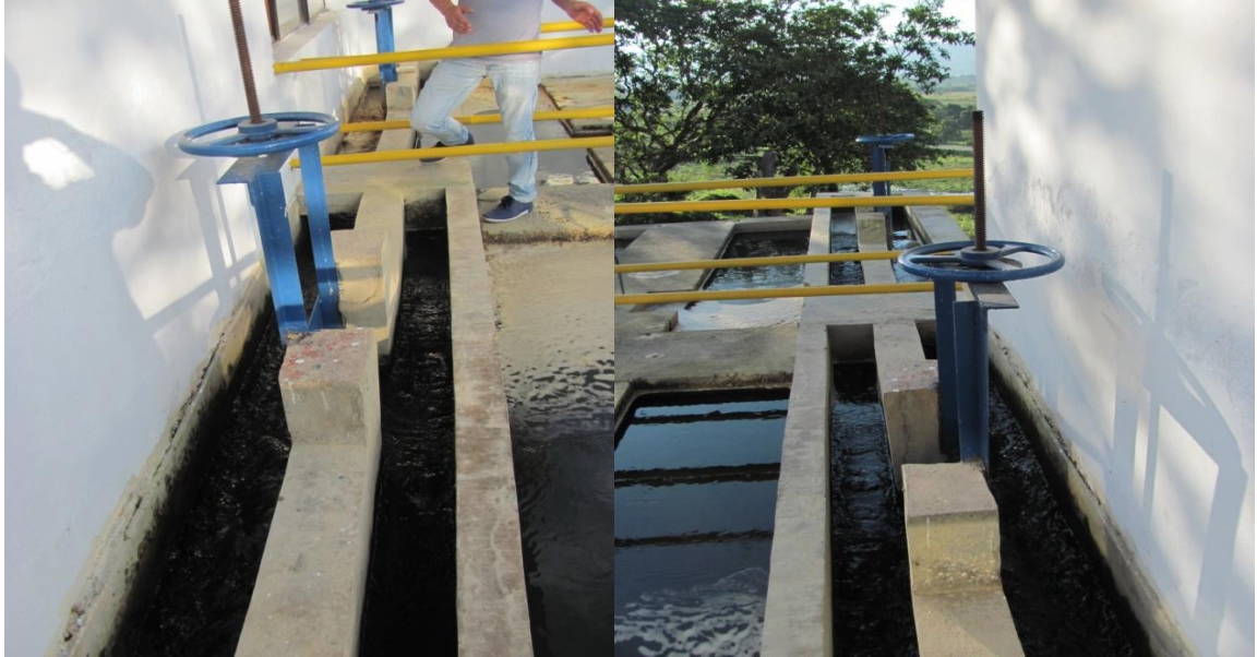
Fotografía 14. Canal de entrada y repartición a floculadores de la Planta de Potabilización N°1.
