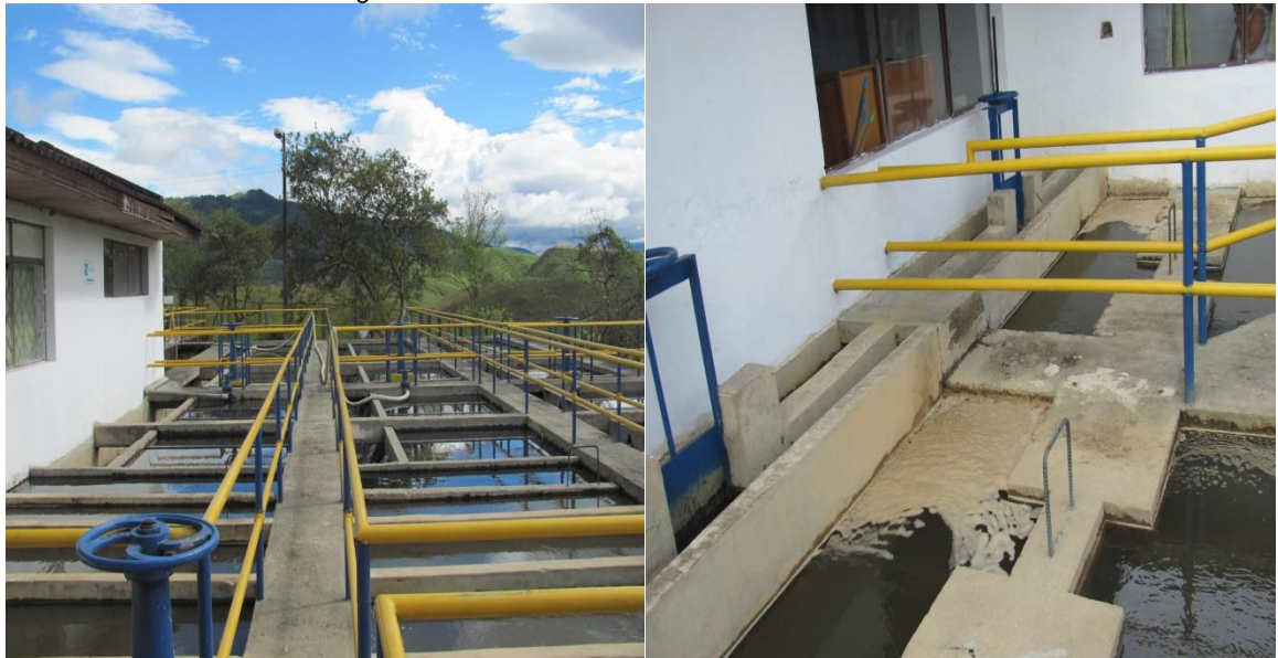
Fotografía 15. Floculadores Planta de Potabilización N°1.
