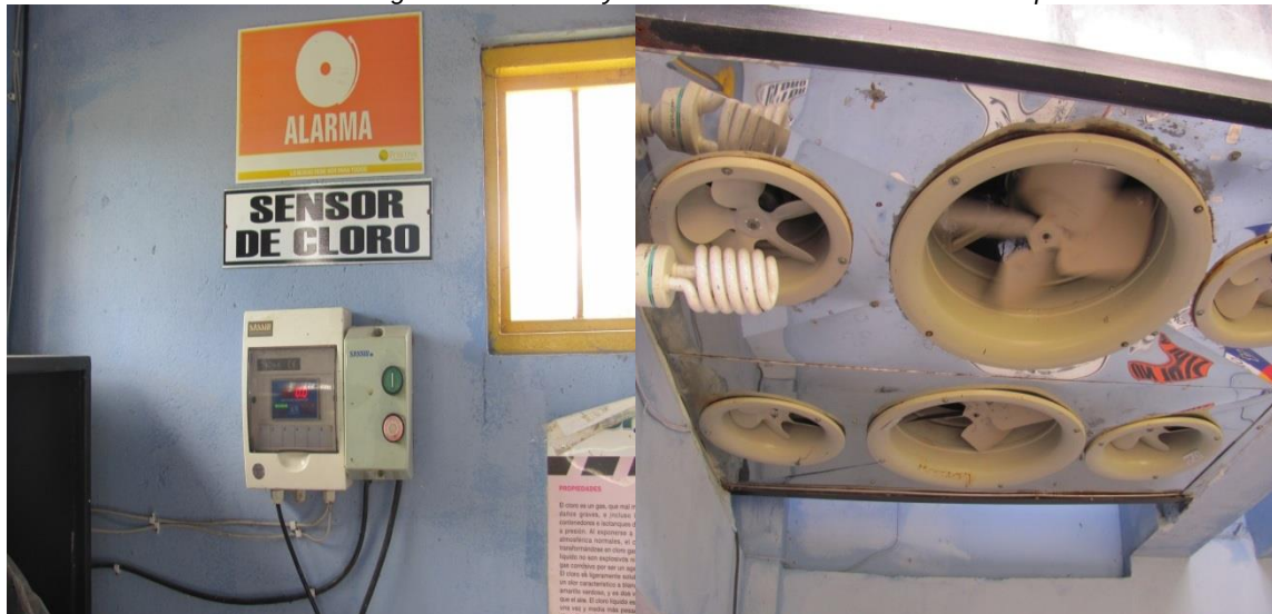
Fotografía 29. Sensor y Extractor del Gas en caso de Escape.
