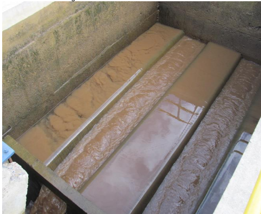
Fotografía 24. Filtro Planta Convencional N°2.
