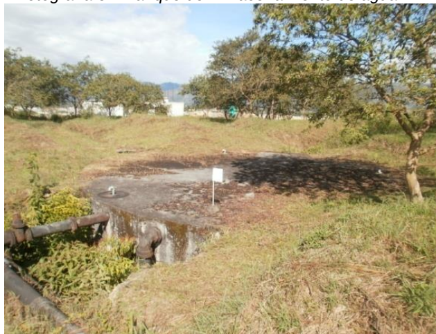
Fotografía 32. Tanque de Almacenamiento de agua # 2.
