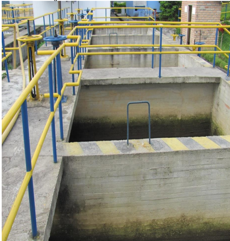
Fotografía 18. Filtros Planta de Potabilización N°1.
