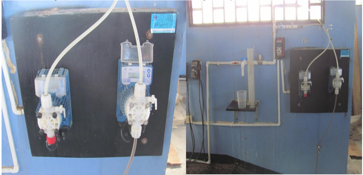
Fotografía 11. Dosificadores automaticos de Coagulante (Hidroxiclورو de Aluminio).
