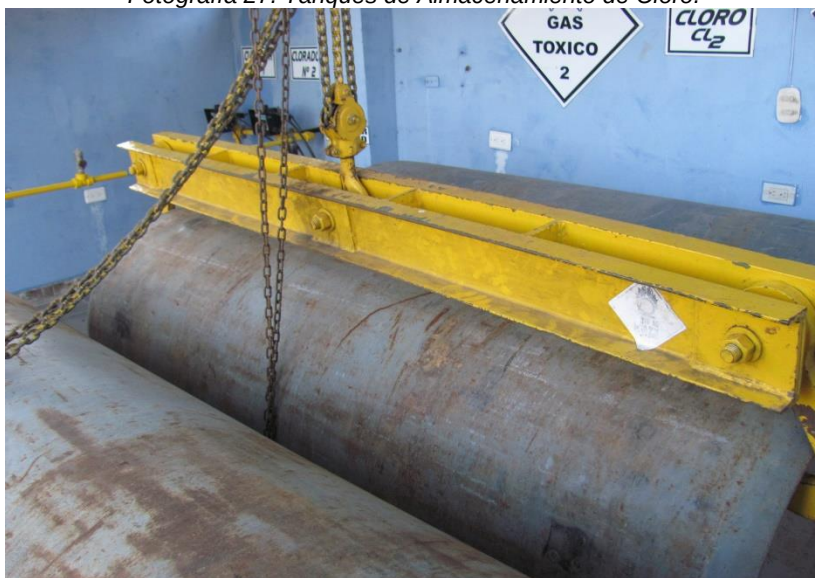
Fotografía 27. Tanques de Almacenamiento de Cloro.
