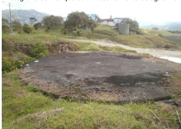
Fotografía 33. Tanque de Almacenamiento de agua # 3.
