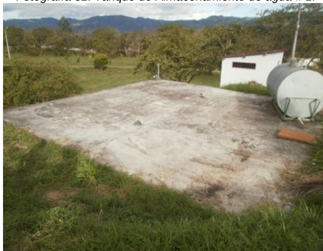
Fotografía 31. Tanque de Almacenamiento de agua # 1.
