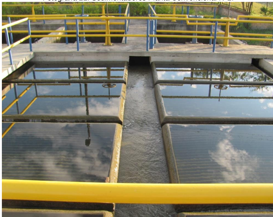
Fotografía 21. Sedimentadores Planta Convencional N°2.
