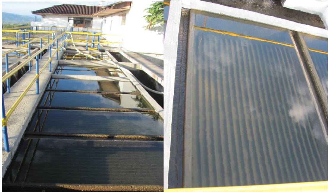
Fotografía 16. Sedimentadores Planta Convencional N°1.
