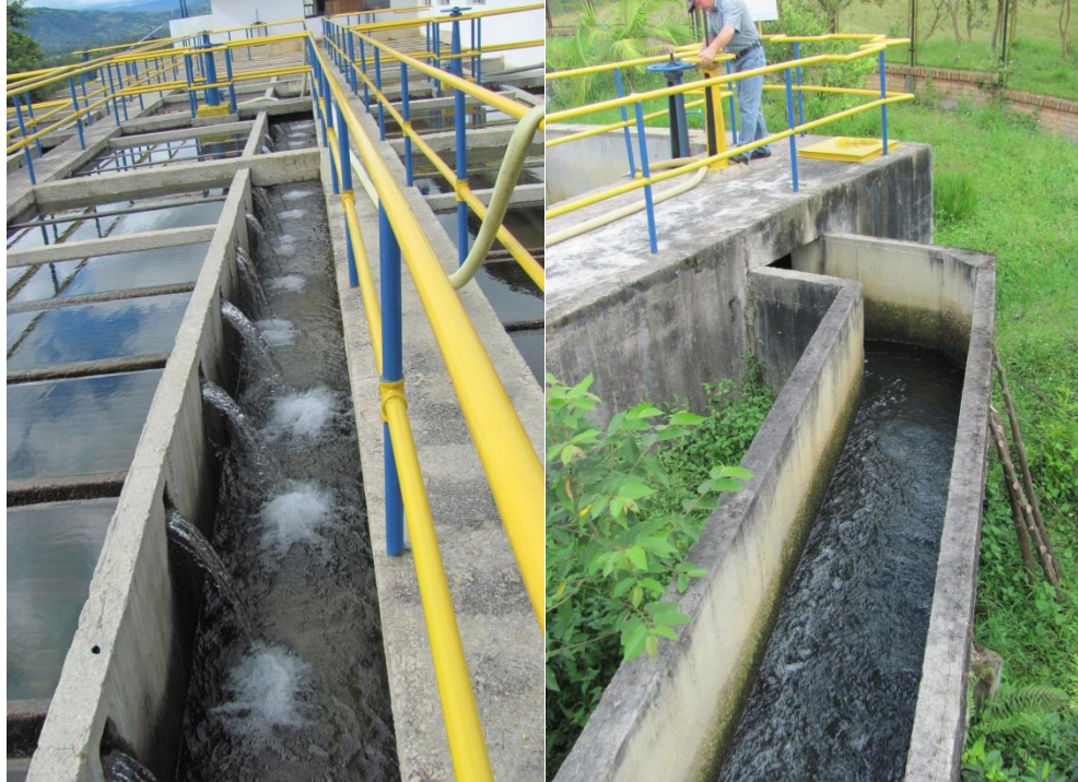
Fotografía 17. Canal de agua sedimentada y canal de distribución de agua sedimentada a filtros.
