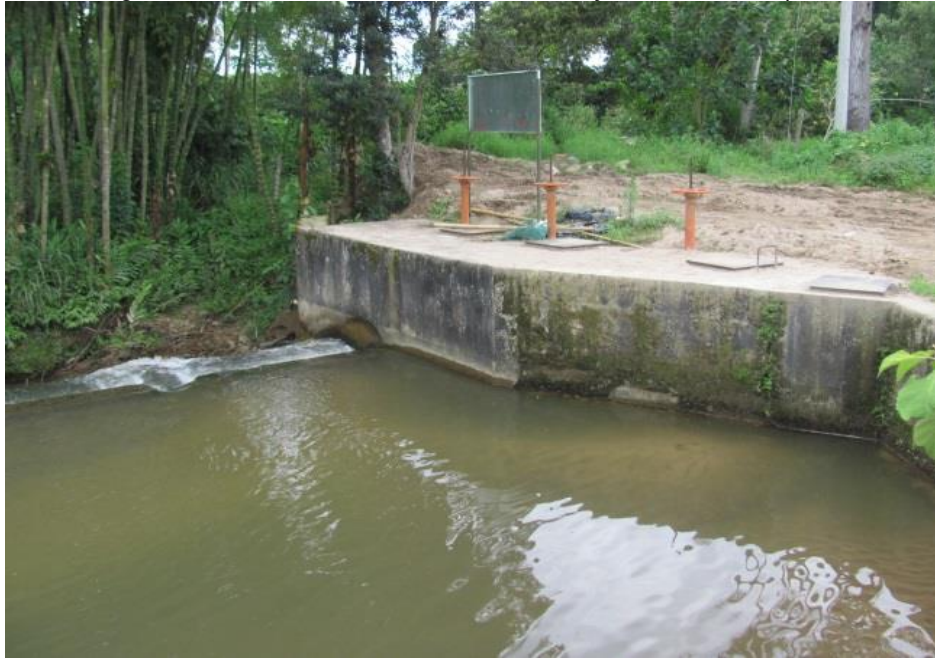
Fotografía 3. Canal de desviación Río Guachicos y estructura de captación.
