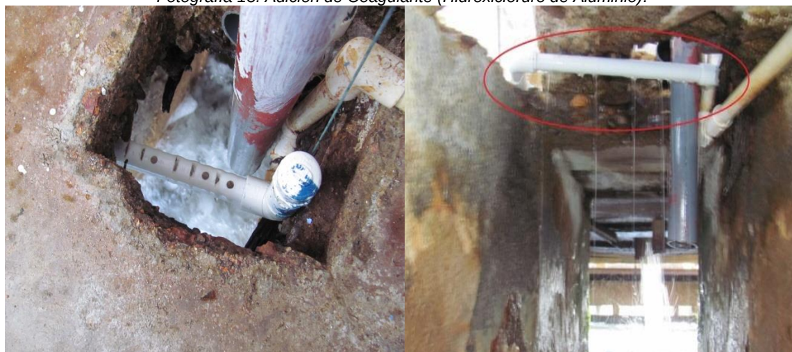
Fotografía 13. Adición de Coagulante (Hidroxiclورو de Aluminio).
