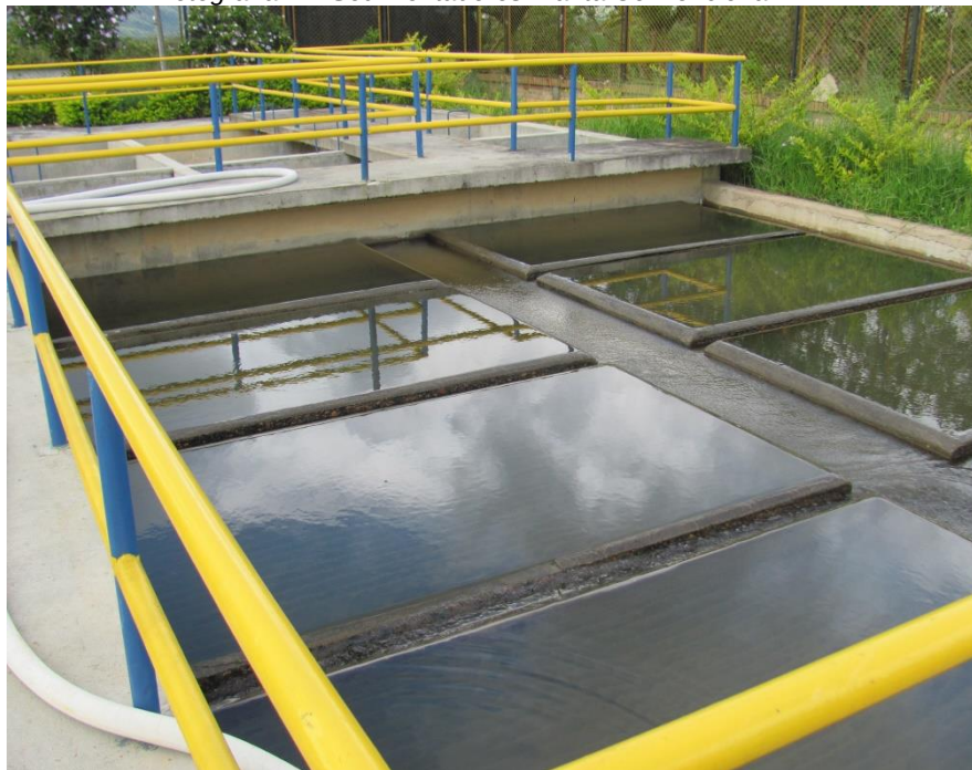
Fotografía 22. Sedimentadores Planta Convencional N°2.
