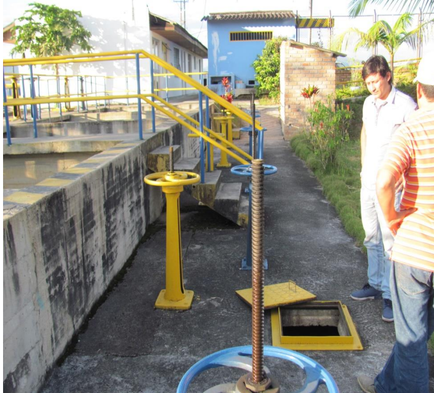
Fotografía 25. Cámara de Cloración (Recepción de caudales de ambas plantas).
