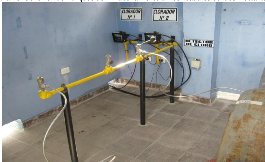
Fotografía 28. Conexión de Tanques de Almacenamiento a Dosificadores del desinfectante (Cloro).
