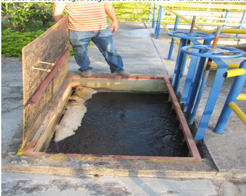
Fotografía 19. Entrada de agua coagulada a Floculadores Planta de Potabilización N°2.
