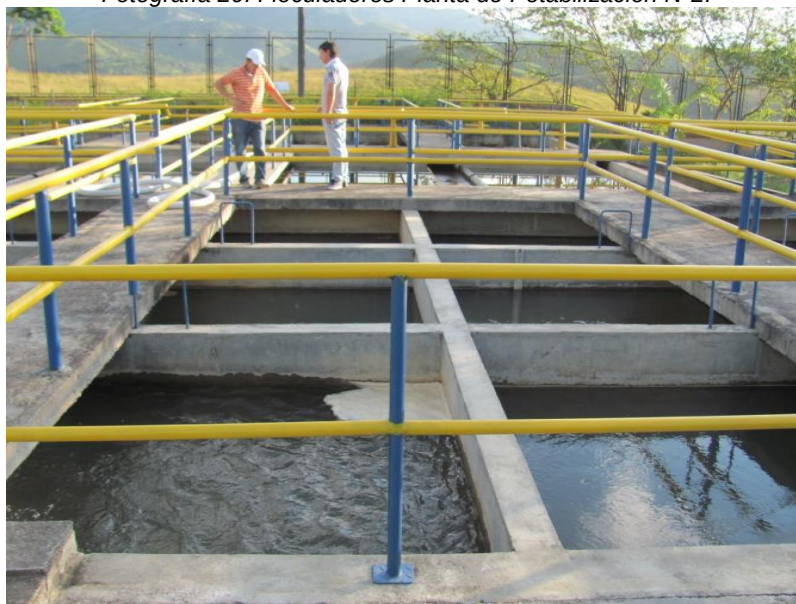
Fotografía 20. Floculadores Planta de Potabilización N°2.
