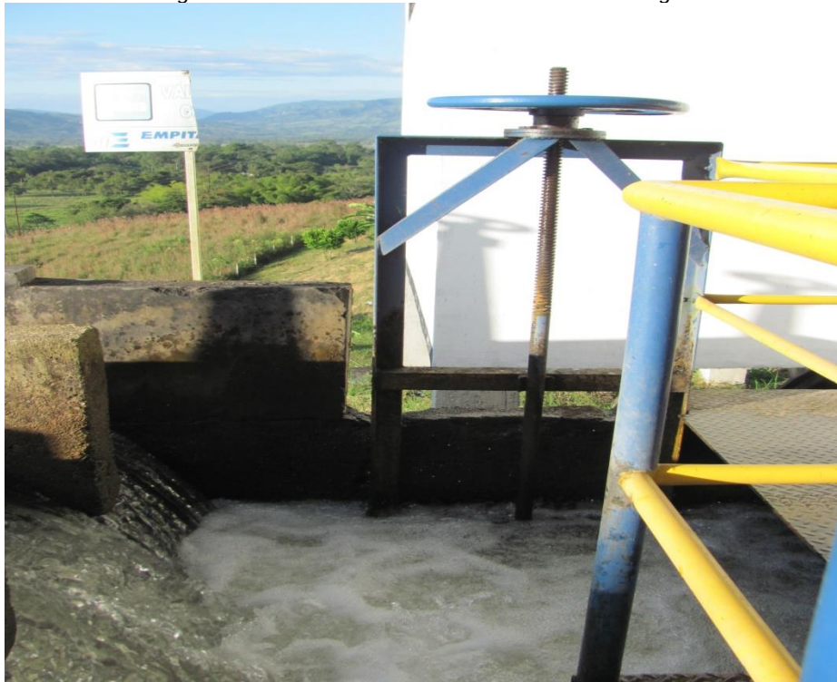
Fotografía 10. Cámara de excesos en la cámara de llegada.
