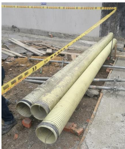
Figura 25: Tubería de desagüe 12"
